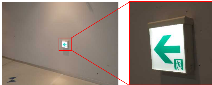
通路誘導灯（廊下・通路）
