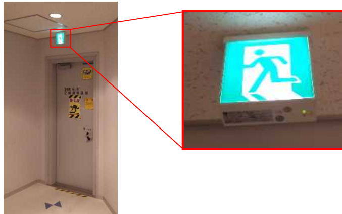
避難口誘導灯
