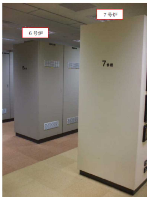
第 2.4.3-2 図 制御盤（裏盤）の色別管理
