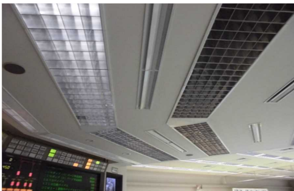
中央制御室照明
