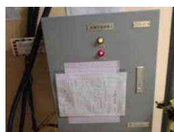
作業用電源箱
