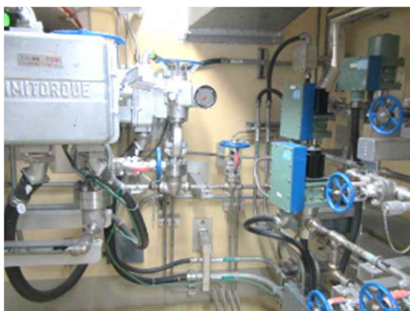
電動弁，電磁弁及び可とう電線管
