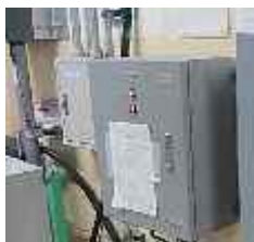
接続箱，作業用電源箱
