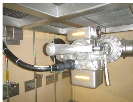
電動弁及び可とう電線管
