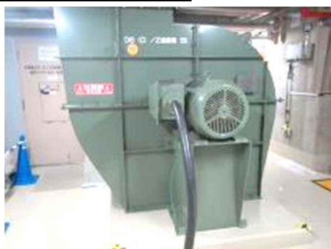
電動機及び可とう電線管
