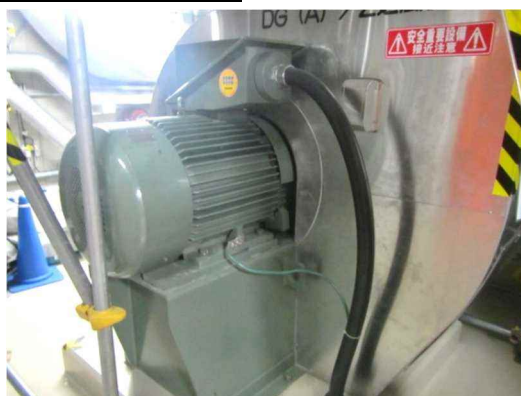
電動機及び可とう電線管
