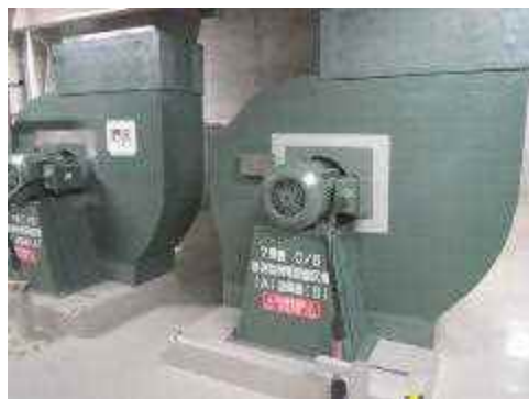
送風機、電動機及び可とう電線管
