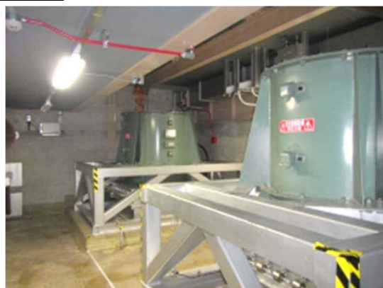
非常用送風機
