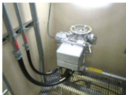
電動弁及び可とう電線管
