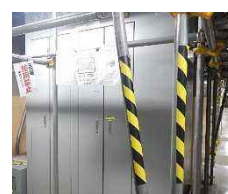
原子炉系多重伝送現場盤
