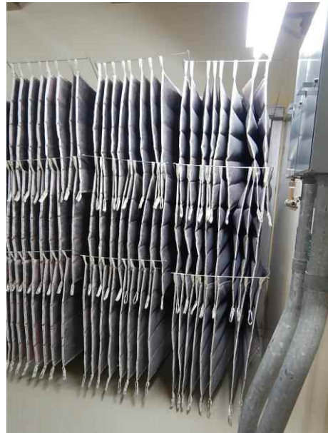
図 1-16：6号炉原子炉建屋3階 非常用ディーゼル発電機(B) エアフィルタ室の概要
