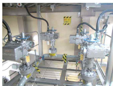
電動弁及び可とう電線管
