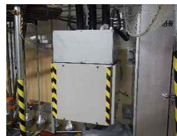
電気ペネトレーション
