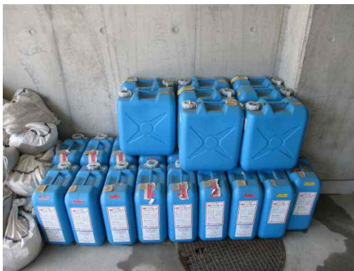
図4 泡消火薬剤ポリタンク 500リットル
