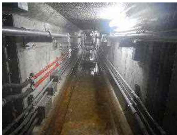
配管及び電線管
