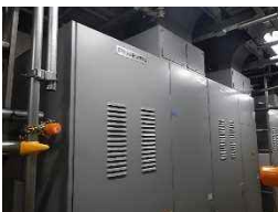
原子炉系多重伝送現場盤
