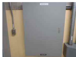
通信設備用分岐箱
