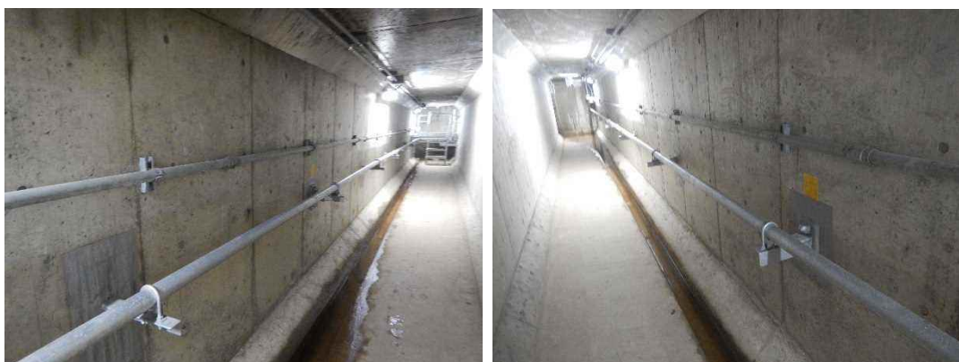
配管及び電線管
