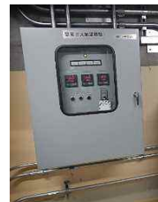
窒素ガス加温器盤
