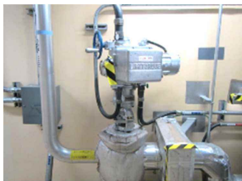
電動弁及び可とう電線管
