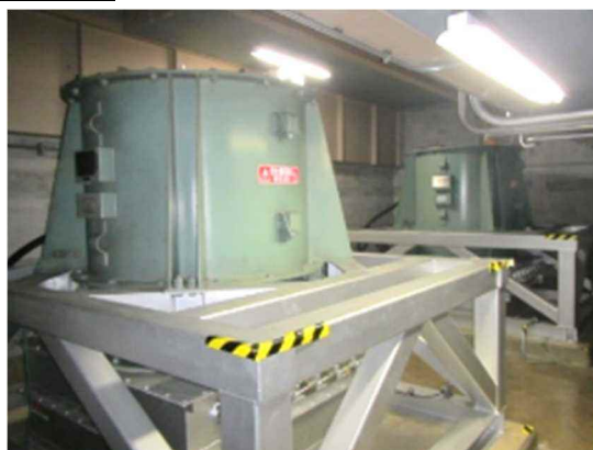
非常用送風機
