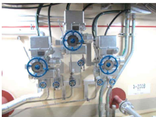
電動弁及び可とう電線管
