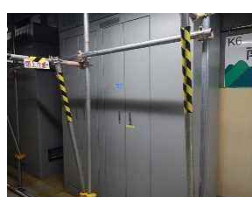
原子炉系多重伝送現場盤
