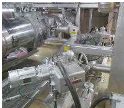
電動弁及び可とう電線管
