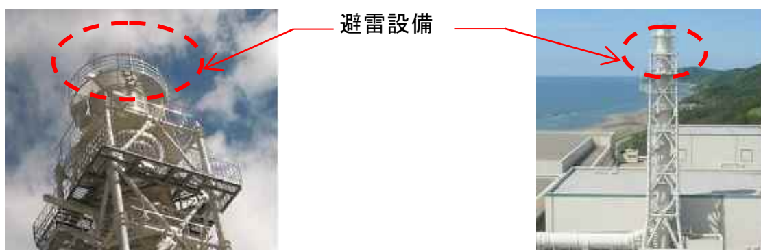
図 1-17：避雷設備の設置例（排気筒）
