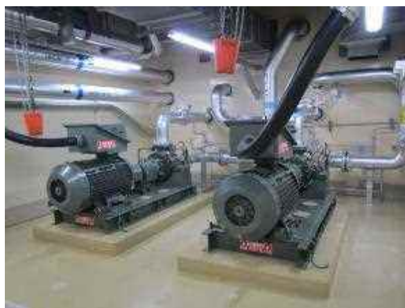
ポンプ及び可とう電線管
