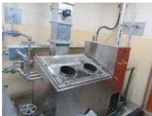
除染シンク及び可とう電線管
