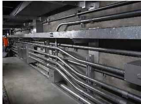
ケーブルトレイ，電線管の例
