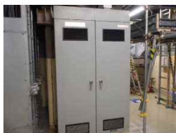
RIP取扱装置現場伝送盤
