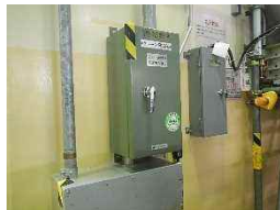
作業用電源箱
