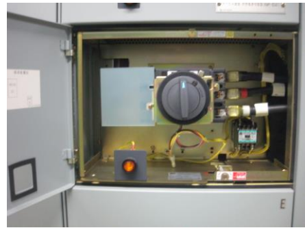
配線用遮断器の例 (MCC)
