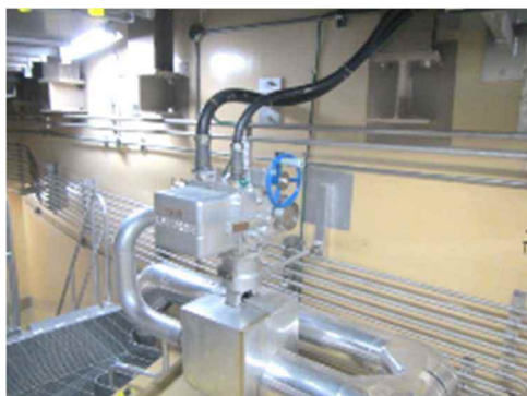
電動弁及び可とう電線管
