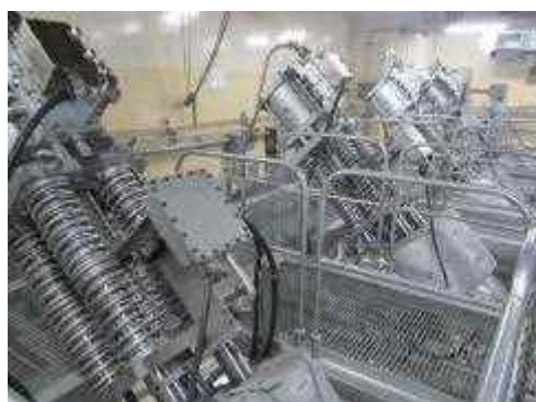
主蒸気隔離弁
