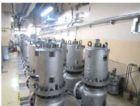
SR V（予備品） ※停止中のため全数取外し仮置き中
