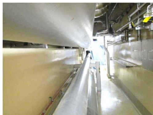
配管及び電線管
