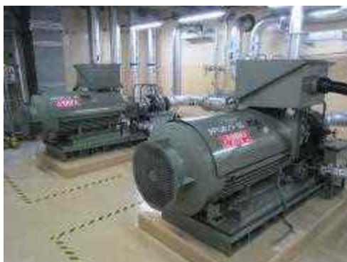
ポンプ及び可とう電線管
