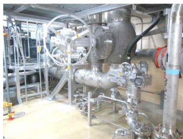
電動弁及び可とう電線管
