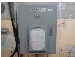
作業用電源箱
