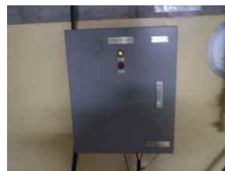
作業用電源箱
