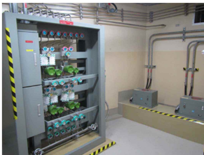
計装ラック及び地震観測装置
