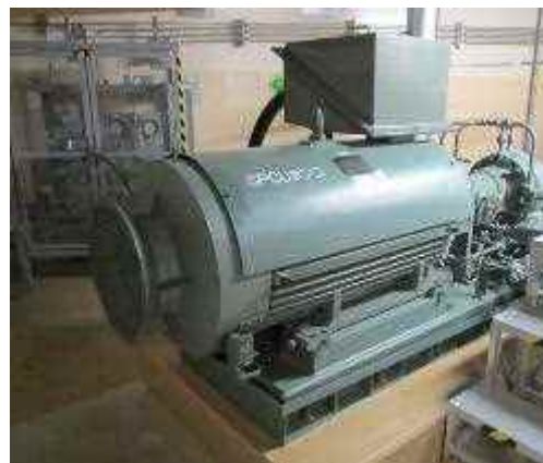
ポンプ及び可とう電線管
