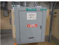
SRNM 前置増幅器盤
