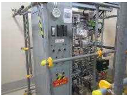
計装ラック及びサンプルポンプ
