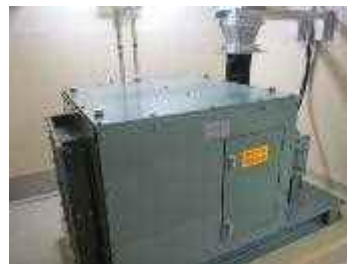
電動機及び可とう電線管
