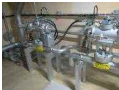
電動弁及び可とう電線管
