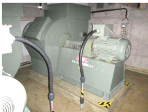
送風機、電動機及び可とう電線管
