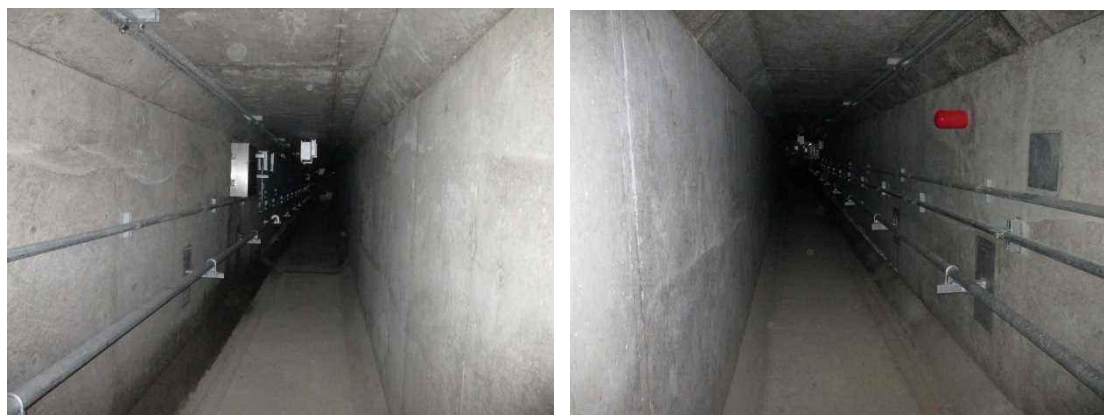
配管及び電線管
