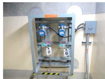
計器（圧力検出器）
