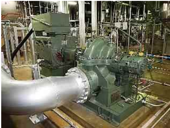
ポンプ，配管，支持構造物の例
