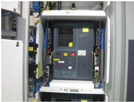
気中遮断器の例 (P/C)
