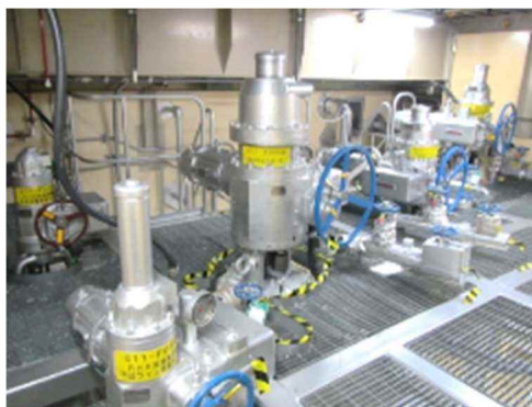
電動弁及び可とう電線管
