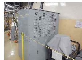
ヒータ用変圧器
