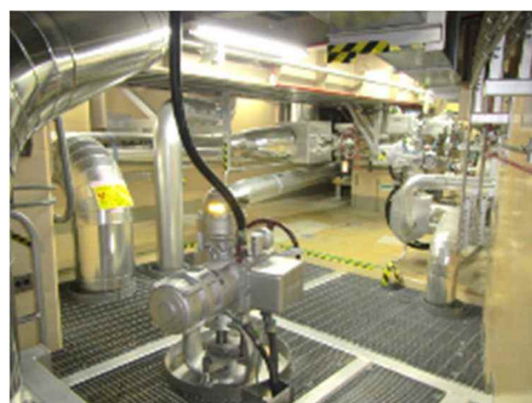
電動弁及び可とう電線管
