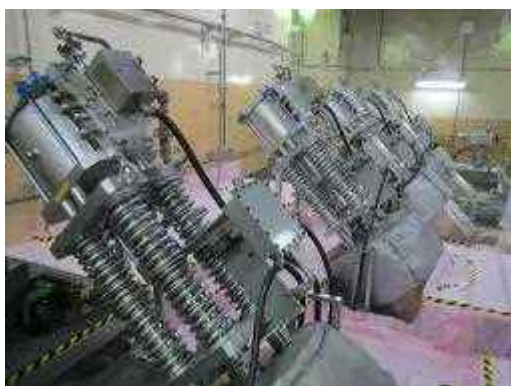
主蒸気隔離弁
