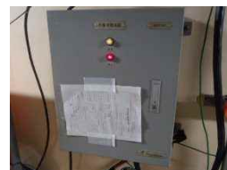
作業用電源箱
