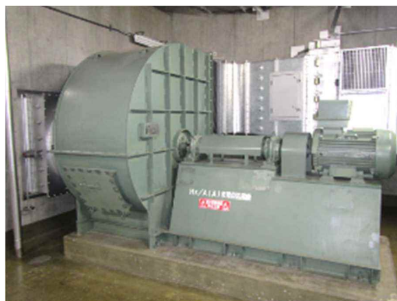
送風機及び電動機
