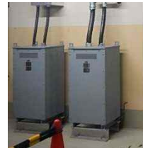
照明用変圧器
