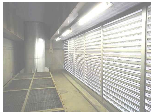
非常用ディーゼル発電機 非常用排気ルーバ室
