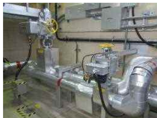
電動弁及び可とう電線管
