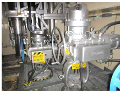
電動弁及び可とう電線管
