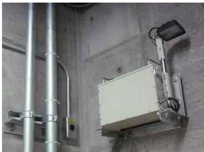
図1-29：消火用非常照明の設置例
