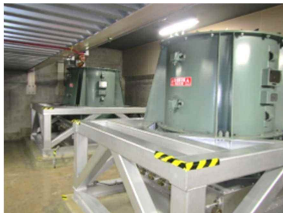
非常用送風機
