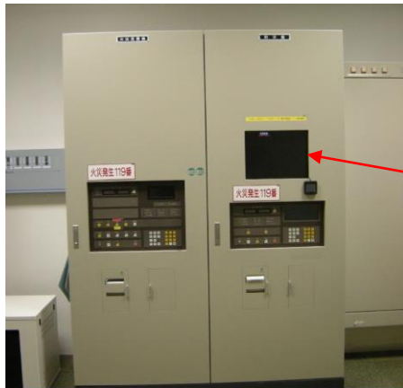
〈火災受信機盤・防災盤〉
