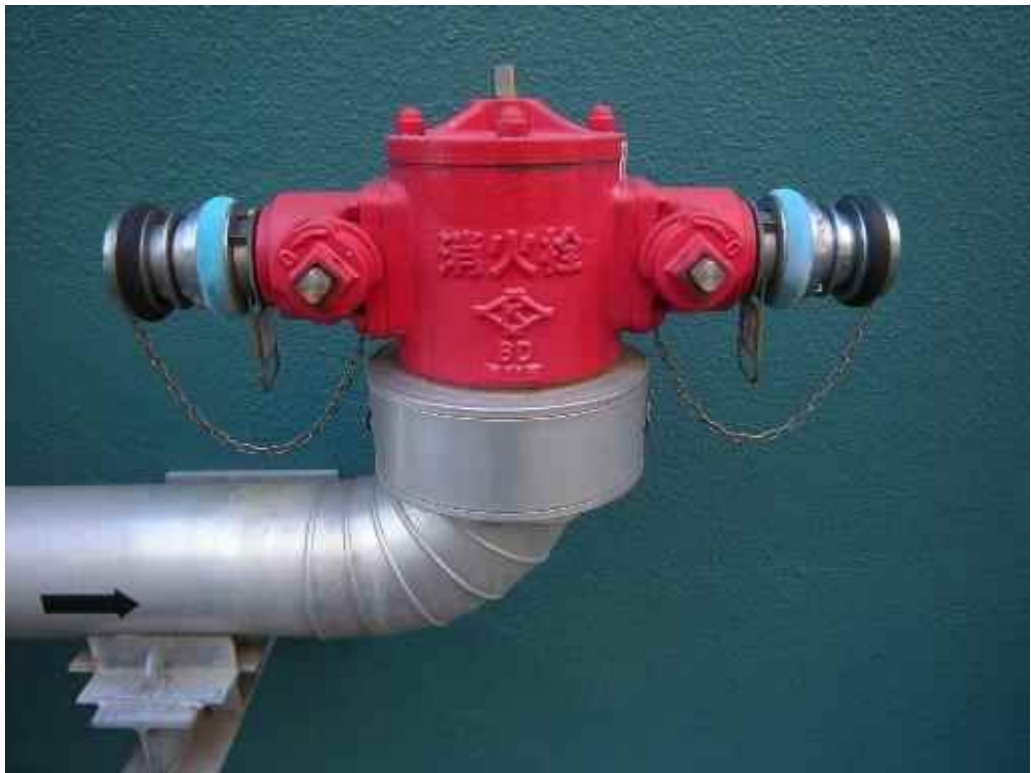
図 1-32：不凍式消火栓の設置状況
