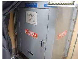
SRNM 前置増幅器盤
