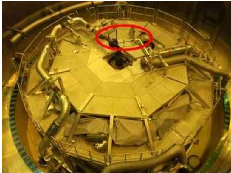
図 1-9：ベント配管の設置例
