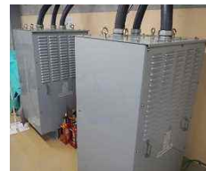
照明用変圧器
