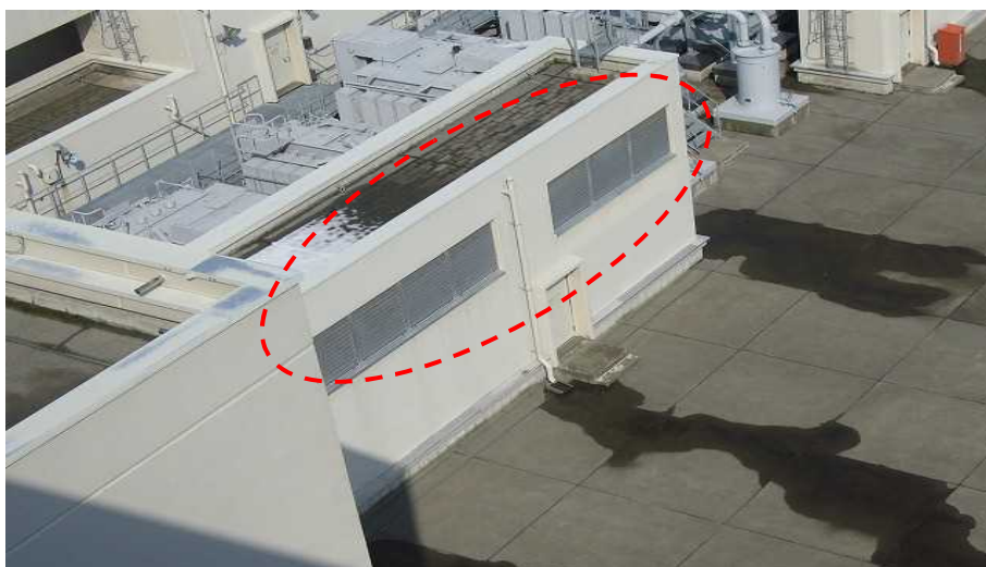
図 6-3 中央制御室換気空調設備の外気取入口
