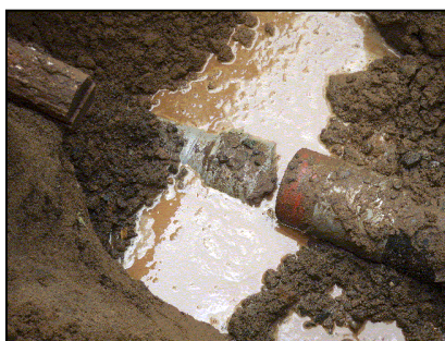
埋設消火配管の損傷
