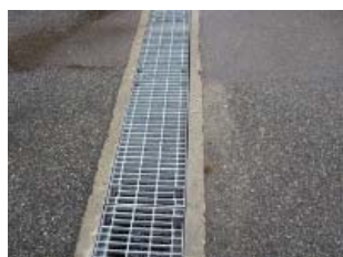
⑤-8 グレーチング
