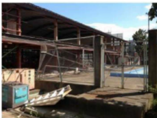
フェンスの被害（工事中の建築物）
