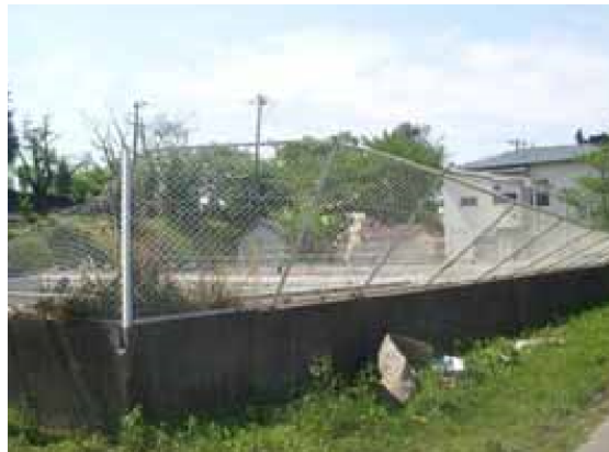
フェンスの被害状況
