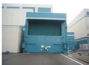
①-13 シャッター (大物搬入口)
