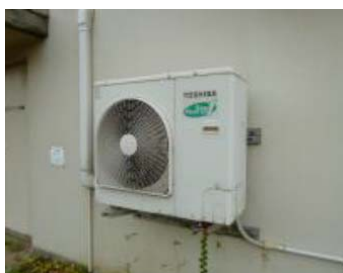
⑦-4 空調室外機
