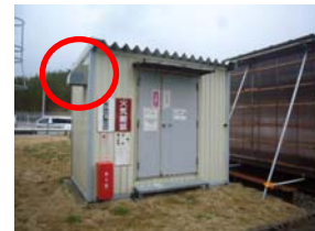
①-24 換気フード
