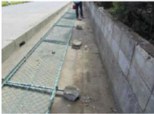
フェンスの倒壊
