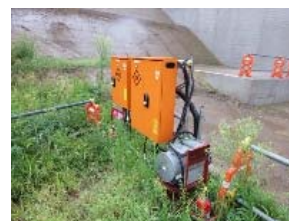
③-3 仮設分電盤
