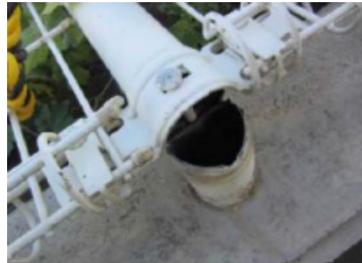
支柱部の破断
