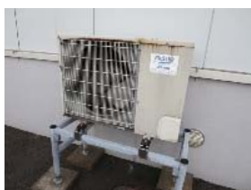
④-14 空調室外機
