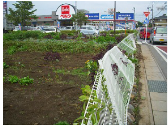
フェンスの変形
