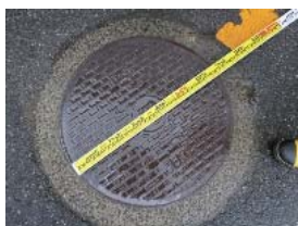
④-1 マンホール蓋
