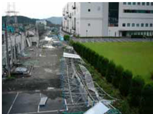
仮設足場の倒壊
