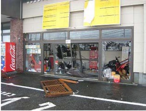
エントランスのガラス破損
