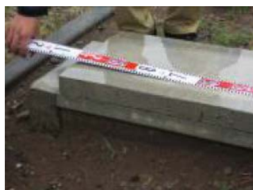
①-5 送水用配管蓋
