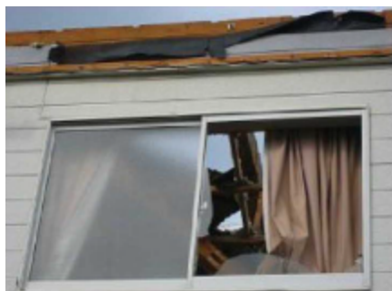
窓ガラスの損壊
