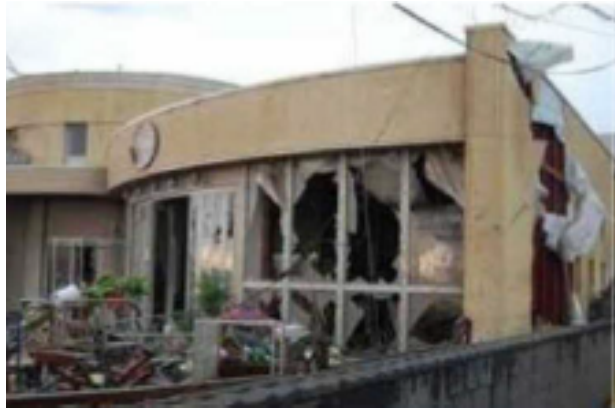
店舗の窓ガラスの被害状況
