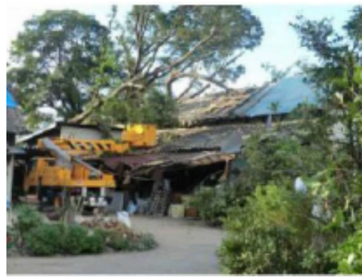
樹木の倒壊による小屋組の被害
