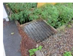
⑤-6 グレーチング
