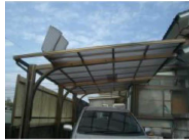
カーボード屋根の破損
