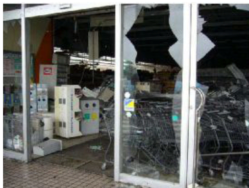
エントランスの窓ガラスの破損
