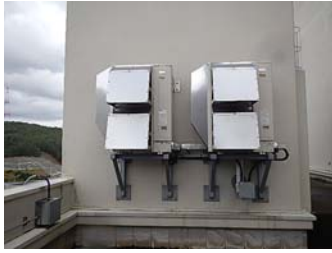
①-13 空調室外機
