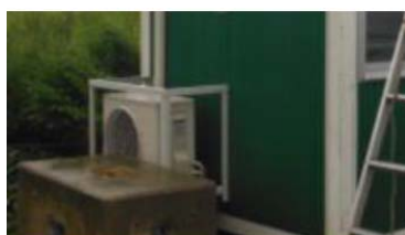
⑥-13 空調室外機
