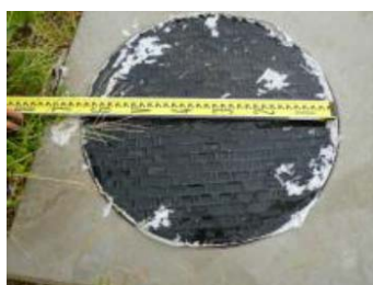
⑦-2 マンホール蓋
