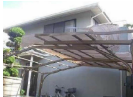
カーボードの被害
