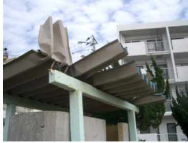
屋外トイレ屋根の損傷
