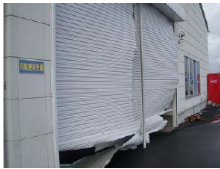
シャッターの破損
