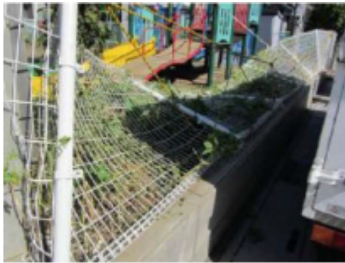
フェンスの倒壊
