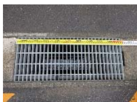
④-2 グレーチング
