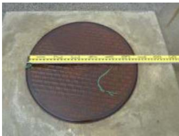
⑦-22 マンホール蓋
