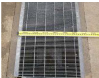
⑦-1 グレーチング
