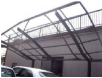
カーボード屋根の飛散及び骨組の損傷
