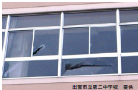
体育館窓ガラスの破損
