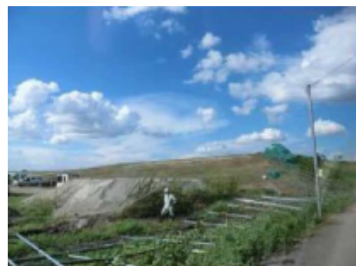
フェンスの被害
