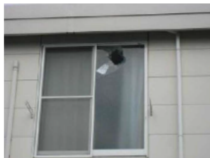
窓ガラスの飛来物衝突痕
