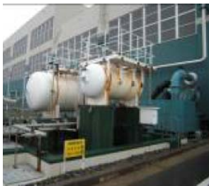
①-31 鋼製タンク
