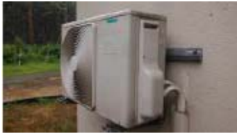
⑥-22 空調室外機
