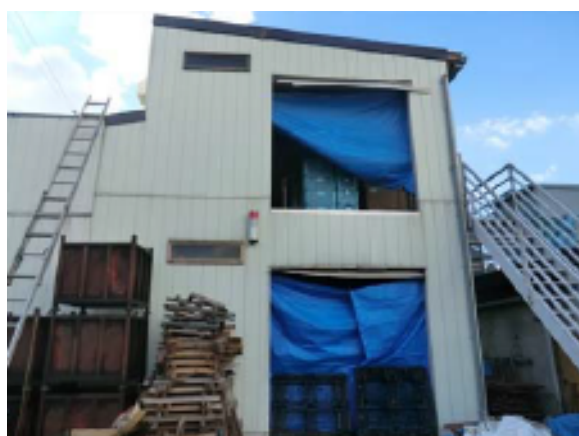
シャッターの被害
