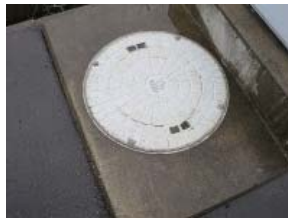
④-56 マンホール蓋
