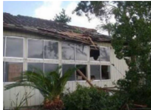
倉庫の窓ガラスと屋根の被害状況
