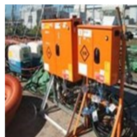
①-6 仮設分電盤
