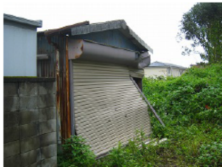
シャッターの外れ
