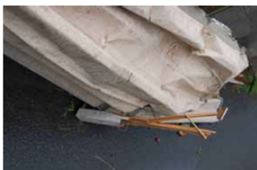
飛散した折板屋根の状況
