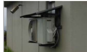
⑥-27 空調室外機
