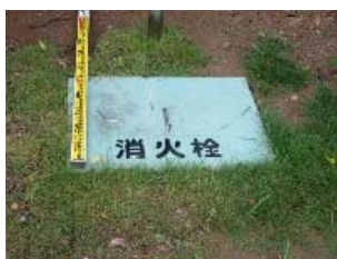
③-10 消火栓蓋
