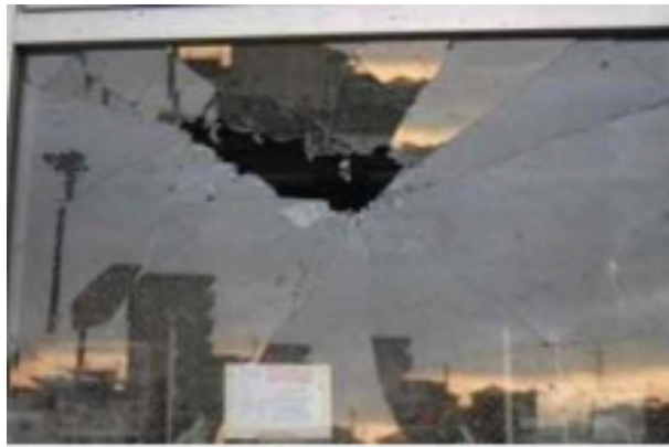
ガラスへの飛来物の衝突痕
