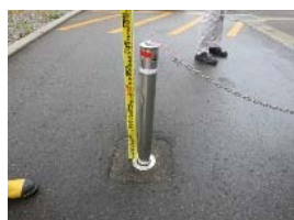
④-13 鋼製車止め
