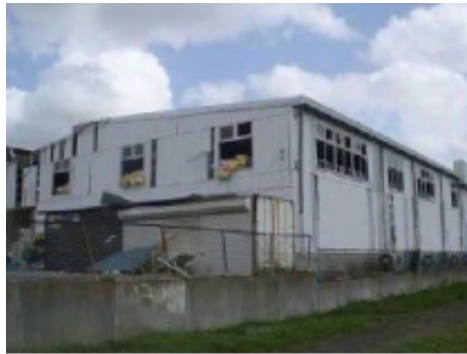
窓ガラスの破損
