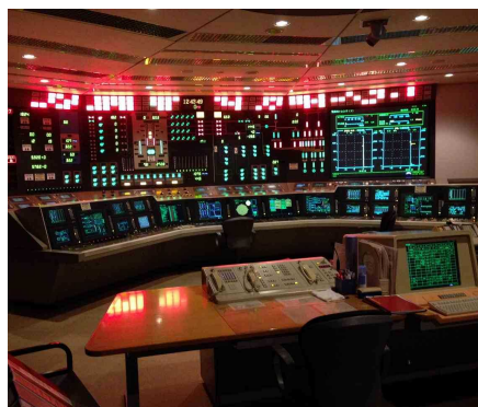
(直流非常灯点灯状態)
