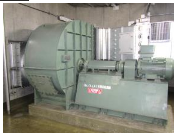
送風機及び電動機
