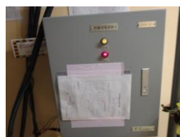
作業用電源箱
