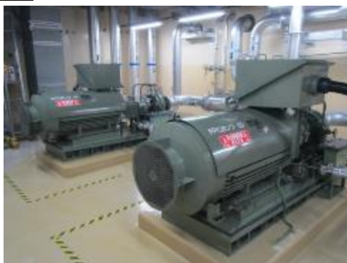
ポンプ及び可とう電線管
