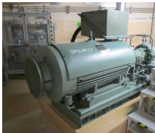
ポンプ及び可とう電線管
