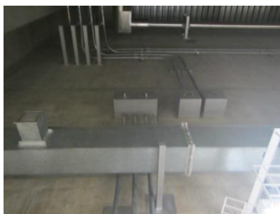
空調ダクト及び可とう電線管
