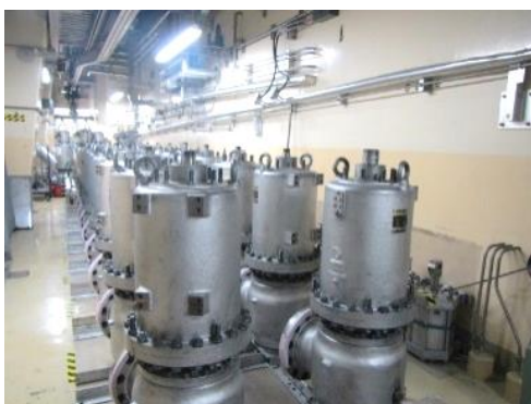
SRV（予備品） ※停止中のため全数取外し仮置き中
