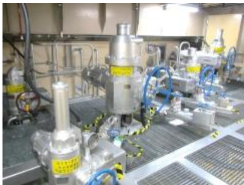
電動弁及び可とう電線管
