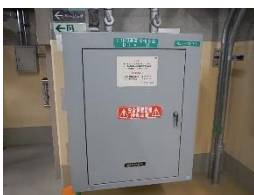
SRNM 前置増幅器盤
