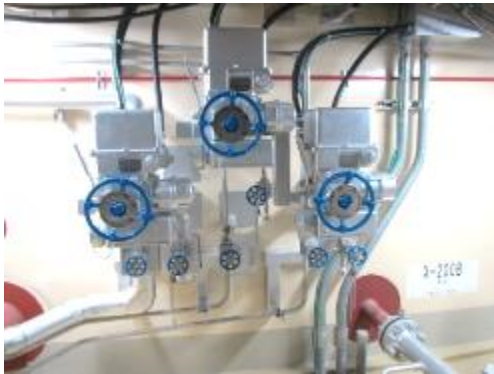
電動弁及び可とう電線管
