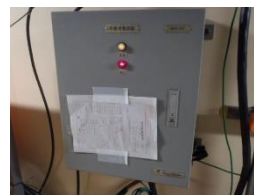
作業用電源箱
