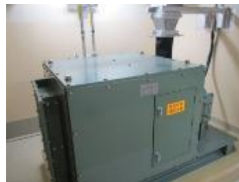
電動機及び可とう電線管
