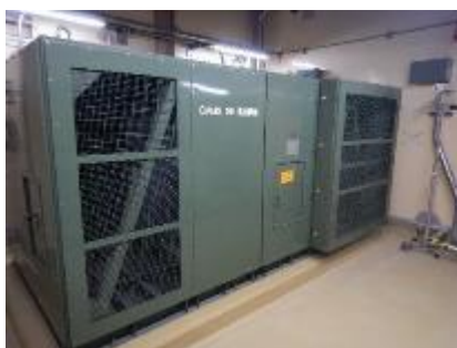
C A M S ( B ) 空調機
