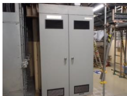
RIP取扱装置現場伝送盤
