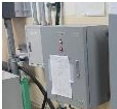
接続箱、作業用電源箱
