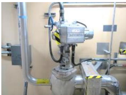
電動弁及び可とう電線管
