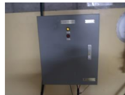
作業用電源箱
