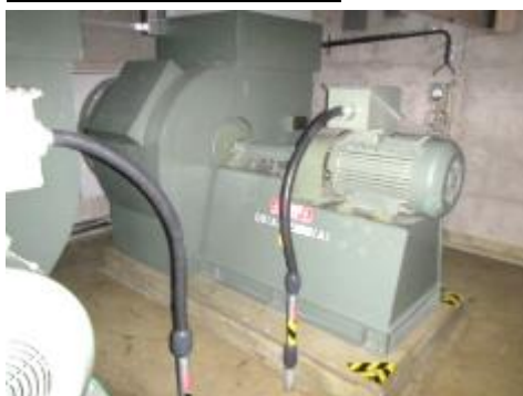
送風機、電動機及び可とう電線管
