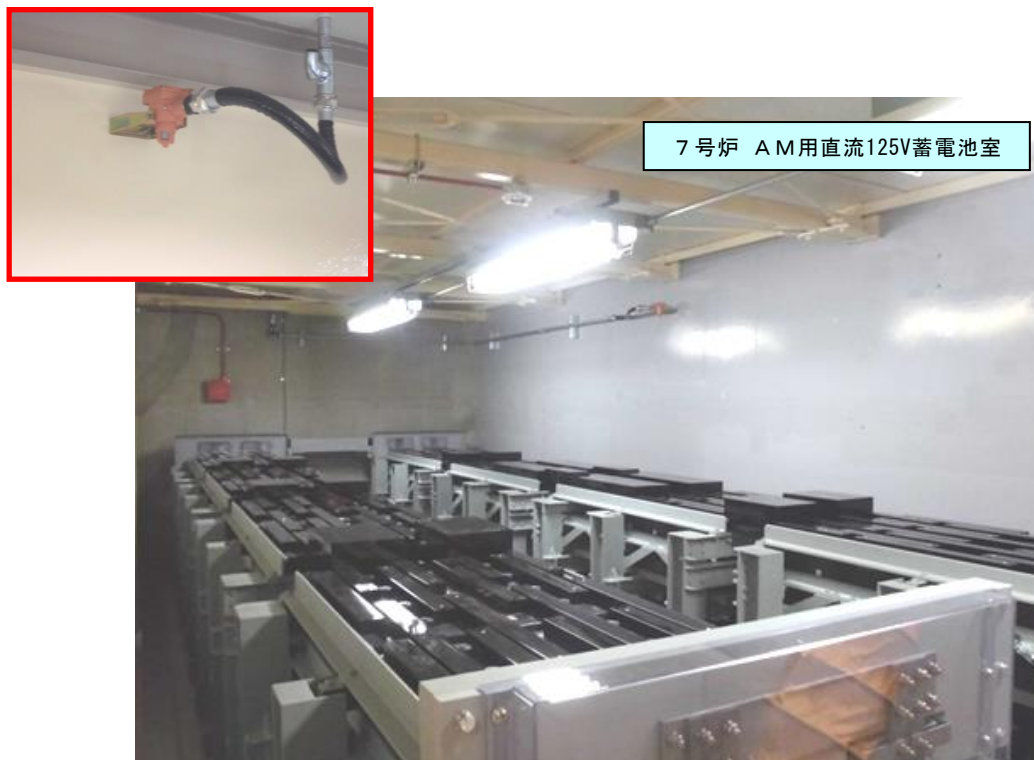
図 41-1-4 : 蓄電池室内の水素濃度検出器設置状況
