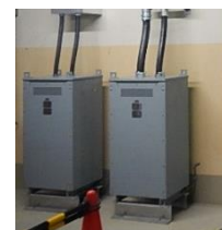
照明用変圧器
