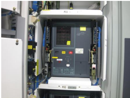
気中遮断器の例 (P/C)
