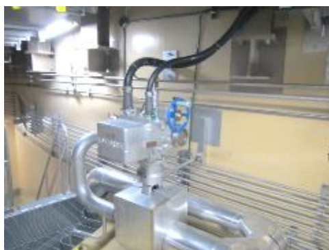
電動弁及び可とう電線管
