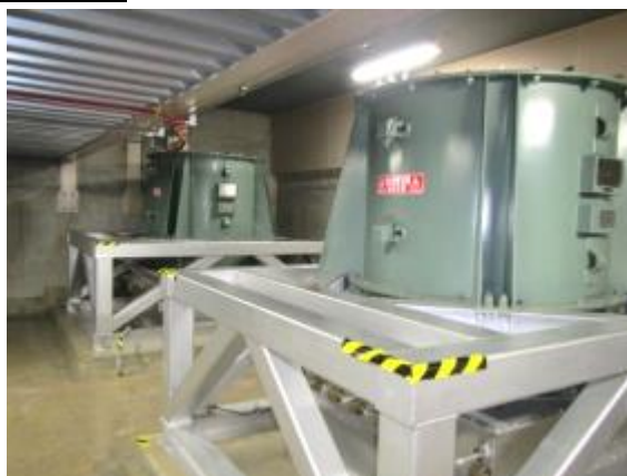
非常用送風機
