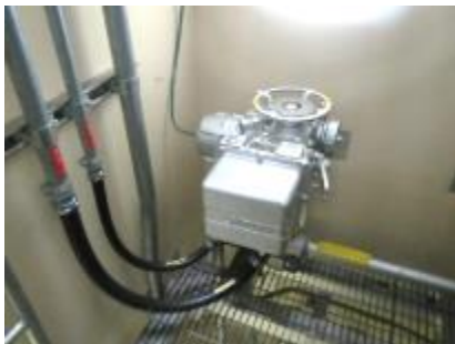
電動弁及び可とう電線管
