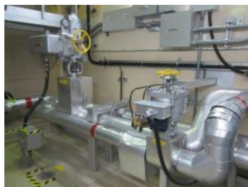
電動弁及び可とう電線管
