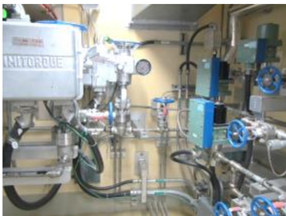
電動弁，電磁弁及び可とう電線管
