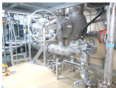
電動弁及び可とう電線管
