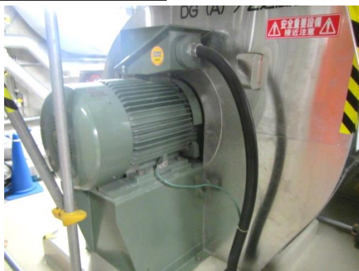
電動機及び可とう電線管
