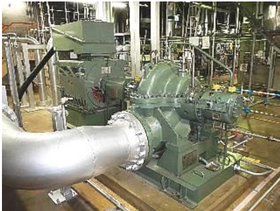
ポンプ，配管，支持構造物の例
