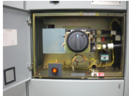
配線用遮断器の例 (MCC)
