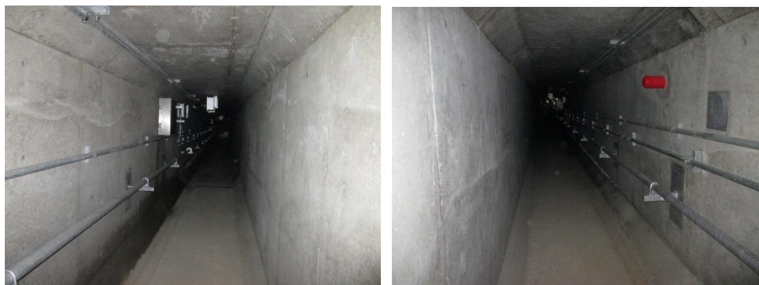
配管及び電線管
