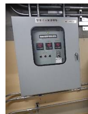
窒素ガス加温器盤
