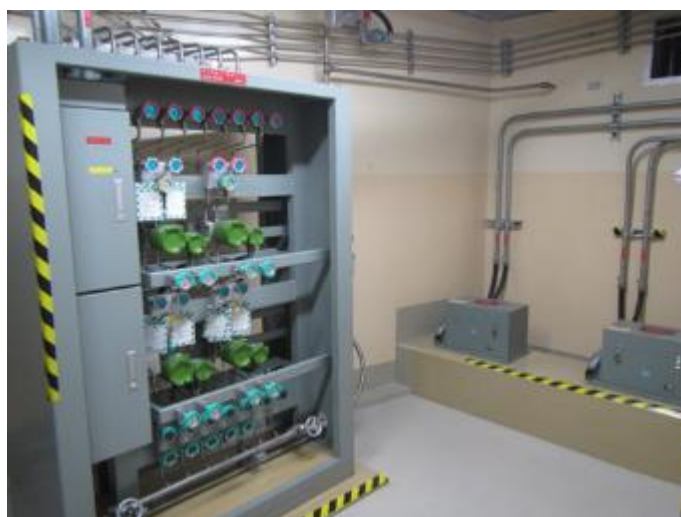
計装ラック及び地震観測装置
