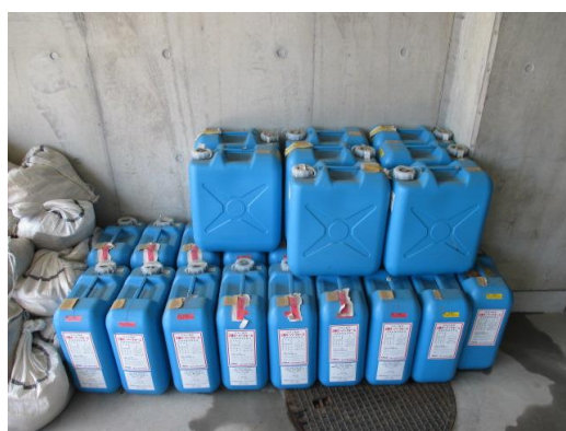
図4 泡消火薬剤ポリタンク 500 リットル
