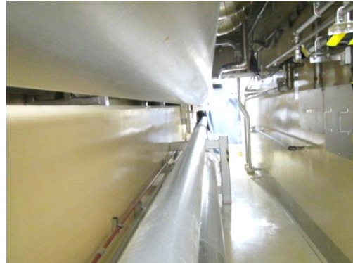
配管及び電線管
