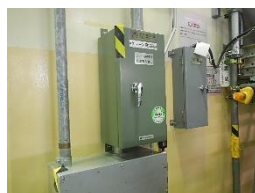
作業用電源箱
