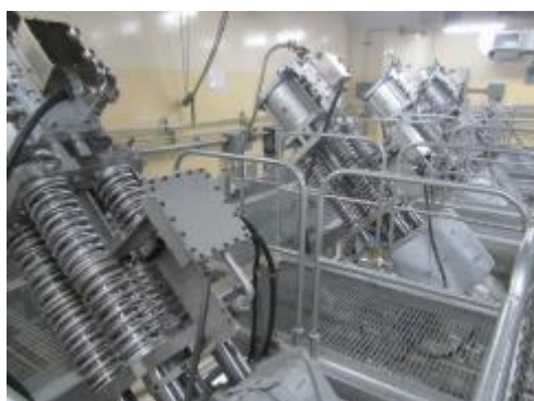
主蒸気隔離弁
