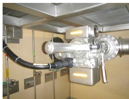
電動弁及び可とう電線管
