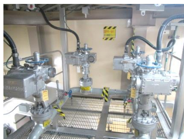
電動弁及び可とう電線管
