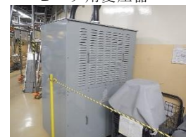
ヒータ用変圧器
