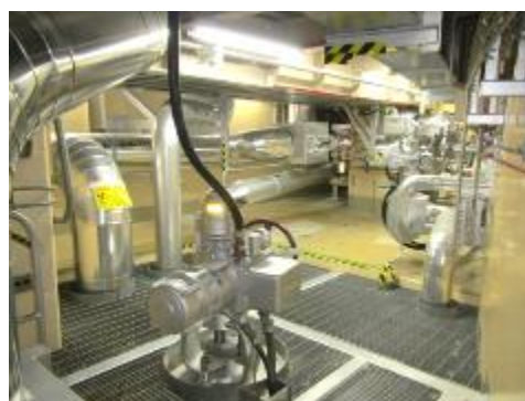
電動弁及び可とう電線管
