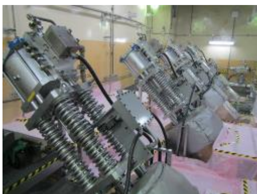
主蒸気隔離弁
