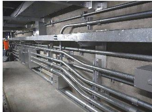
ケーブルトレイ，電線管の例
