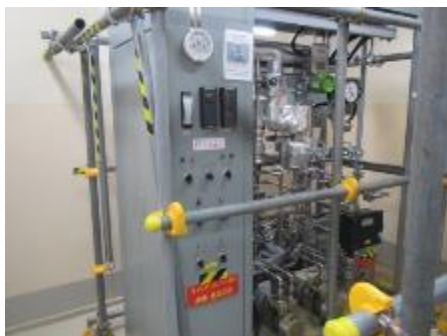
計装ラック及びサンプルポンプ
