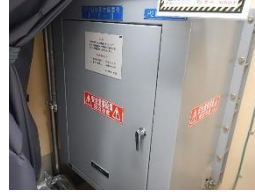
SRNM 前置増幅器盤
