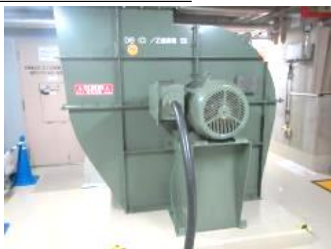
電動機及び可とう電線管
