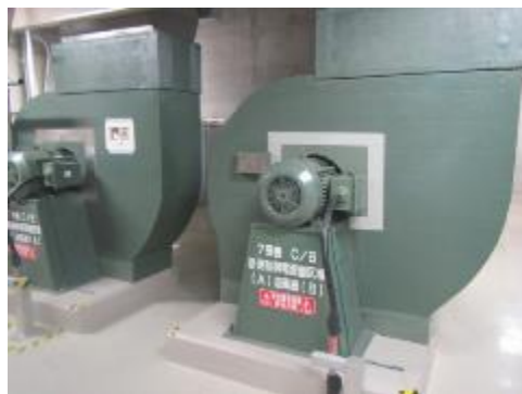
送風機、電動機及び可とう電線管
