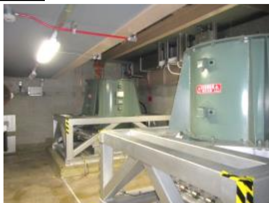
非常用送風機
