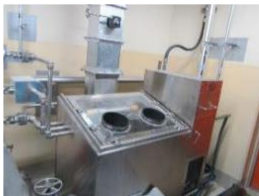
除染シンク及び可とう電線管
