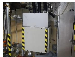
電気ペネトレーション
