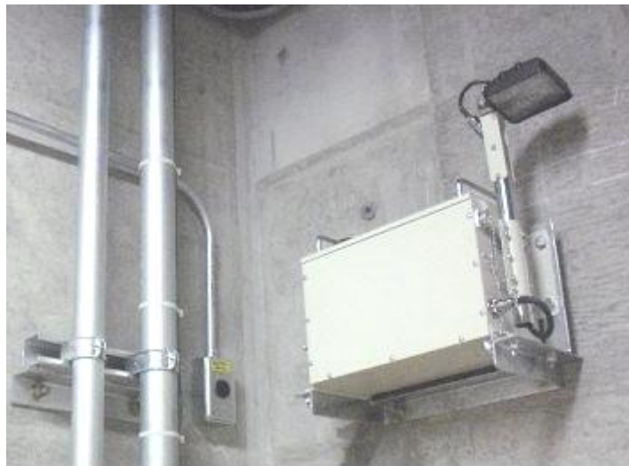
図 41-1-34：消火用非常照明の設置例
