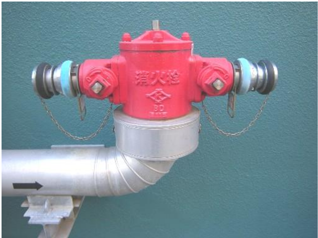
図 41-1-38 : 不凍式消火栓の設置状況
