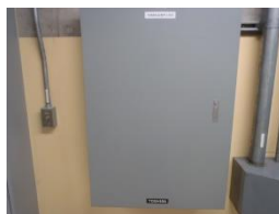
通信設備用分岐箱
