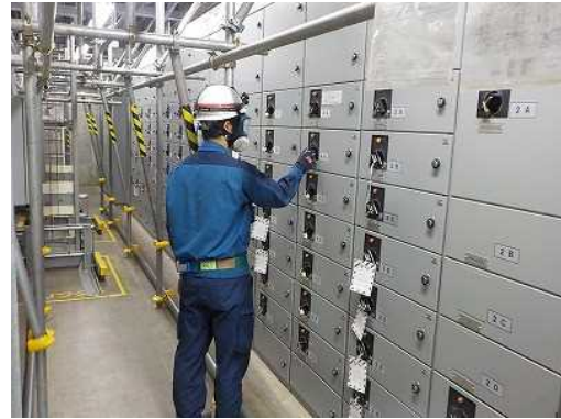
電源復旧操作
