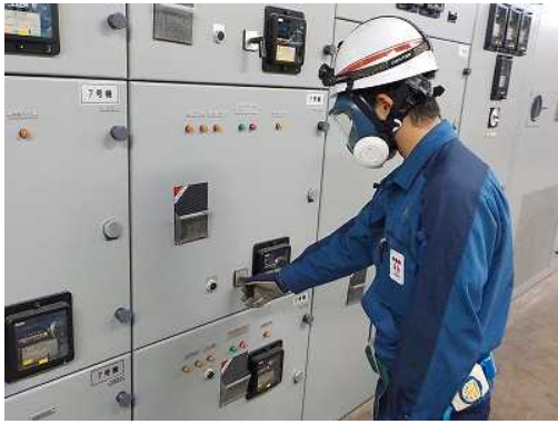
電源の受電操作
