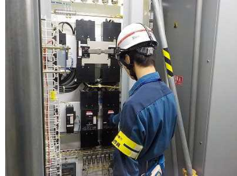
計器電源復旧(D系)
