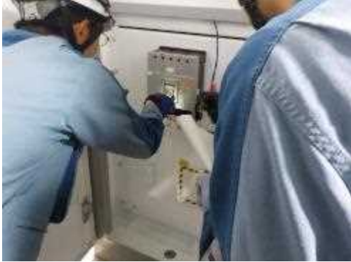
受電操作(同時投入防止用切替盤)
