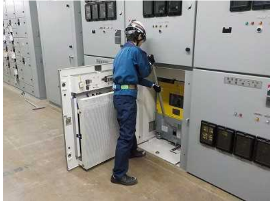
緊急用 M/C 遮断器手動投入
