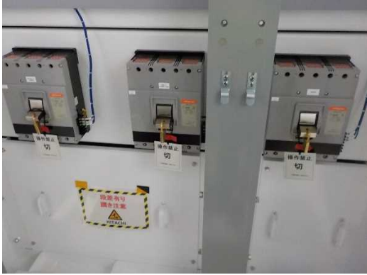
同時投入防止用切替盤
