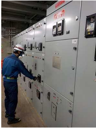
電源の受電操作
