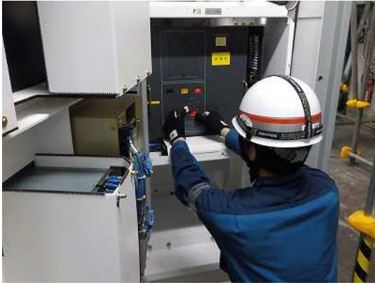
蓄電池遮断器手動開放
