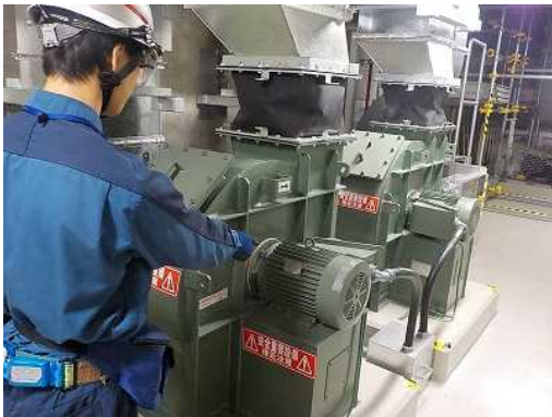
空調機運転状態確認
