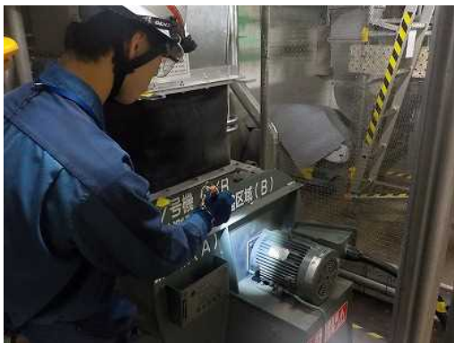
空調機運転状態確認
