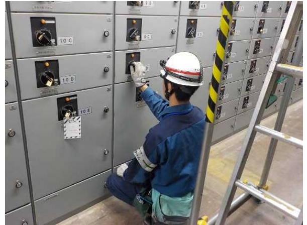
電源復旧操作
