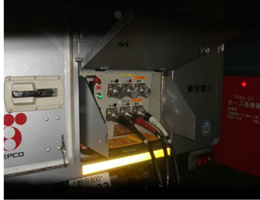
高圧ケーブル接続箇所(電源車)
