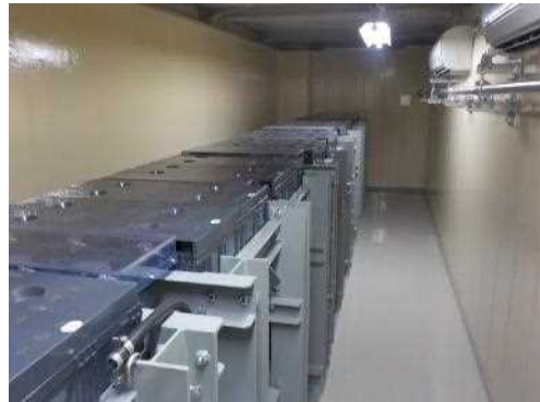
AM 用蓄電池
