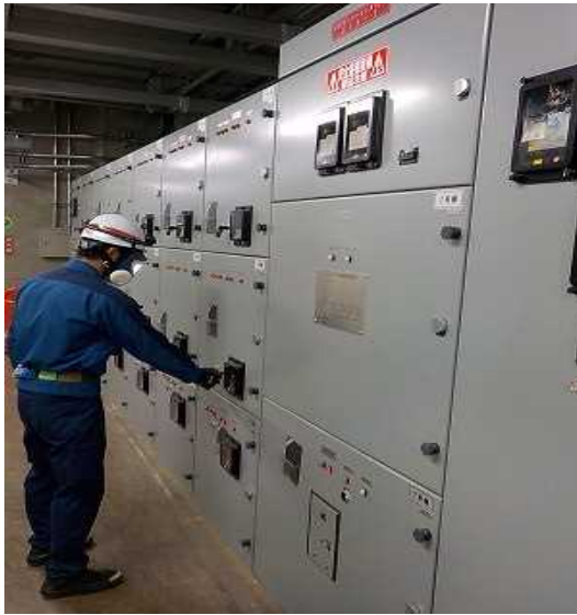
電源受電操作
