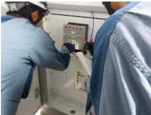
同時投入防止用盤切替盤
