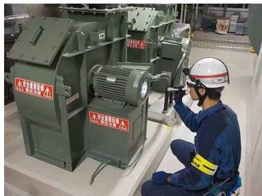
空調機運転状態確認
