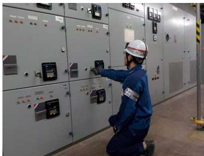
電源受電操作
