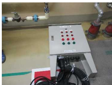
制御盤設置状況
