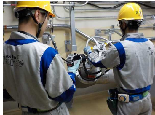
復水移送ポンプ吸込ライン切替
