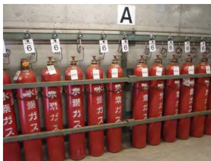
水素ポンプの固縛状況（6号炉）
