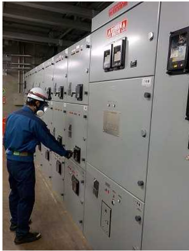
電源の受電操作
