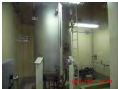
雑固体廃棄物焼却設備 廃油タンク設置状況
