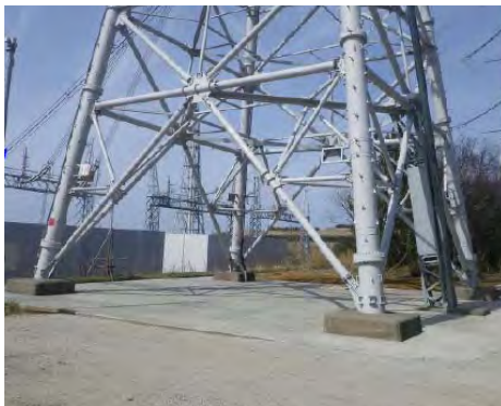
新新潟幹線 No. 1 送電鉄塔
