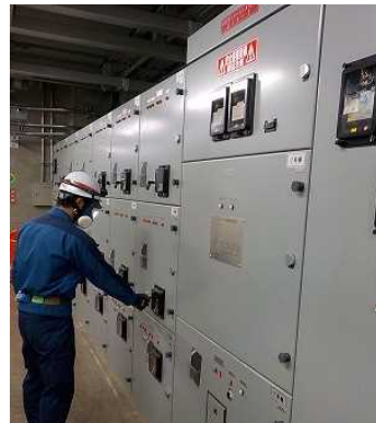
電源受電操作
