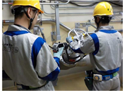
復水移送ポンプ吸込ライン切替
