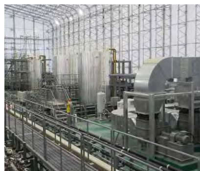
処理水タンク・供給タンクエリア
