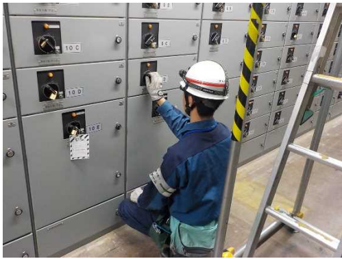
電源復旧操作
