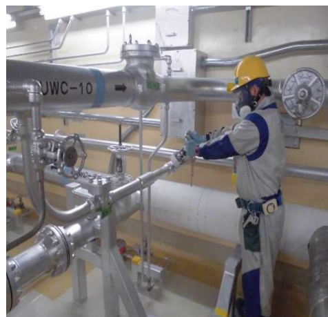
復水移送ポンプミニフローライン隔離
