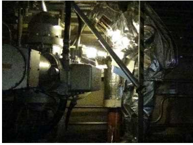
原子炉隔離時冷却系 起動操作
