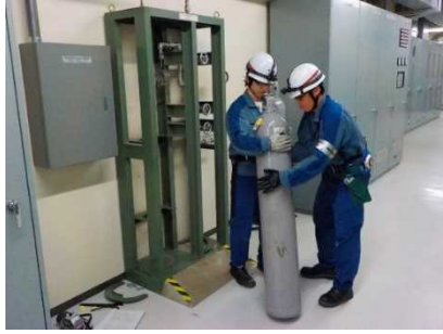
予備ポンベ交換
