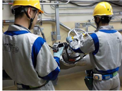
復水移送ポンプ吸込ライン切替
