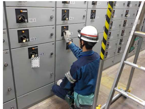
電源復旧操作
