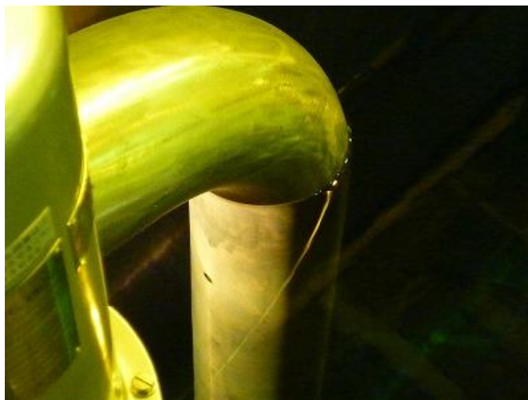
図1 サイフォンブレーク孔の設置状況
