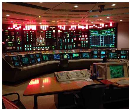
(直流非常灯点灯状態)
