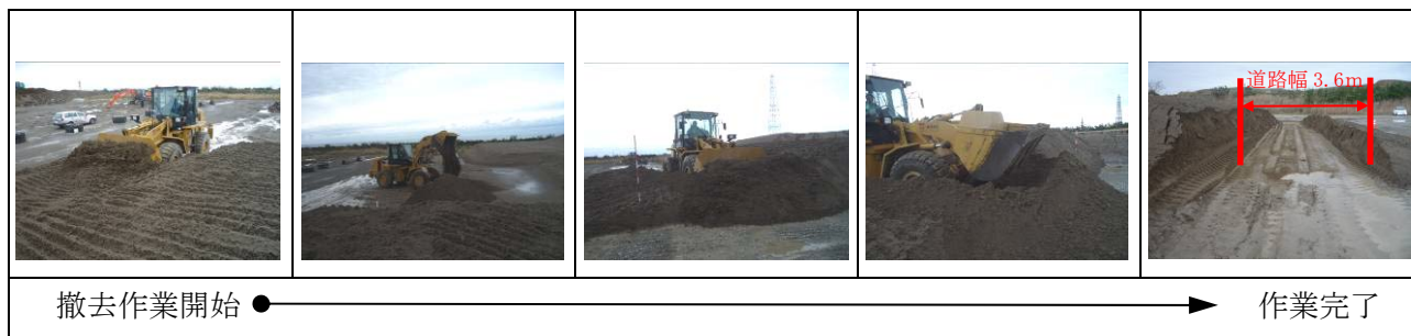
図 5 崩壊土砂撤去状況写真
