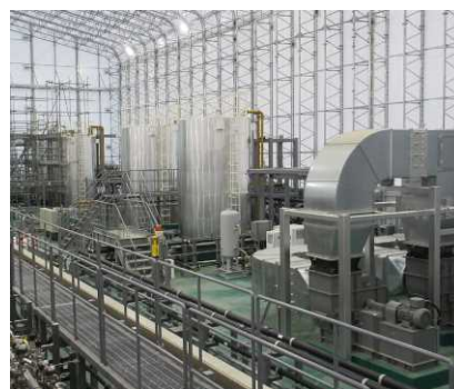
処理水タンク・供給タンクエリア
