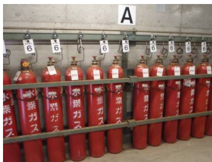
水素ボンベの固縛状況 (6号炉)
