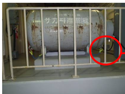
雑固体廃棄物焼却設備プロパン庫
