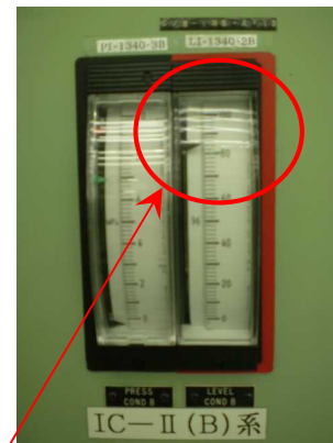
IC(B)蒸気圧力計,水位計 （後日撮影）
