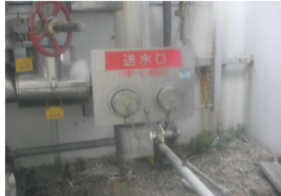
1号機消火系送水口
