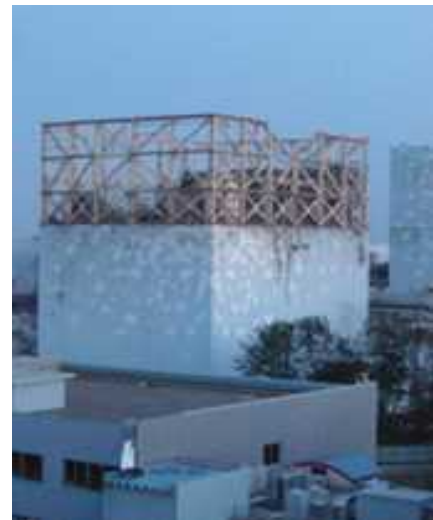
爆発後の1号機原子炉建屋
