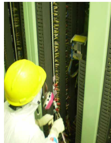
制御盤裏 （後日撮影 照明あり）
