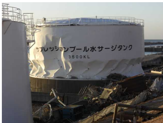
津波で変形したタンク (上の写真の右のタンクと同一)
