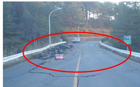
5,6号へのアクセス道路の損傷状況 (復旧後の状況。片側の道路の舗装をはいで、 碎石や砂利を流用して片側車線を復旧)
