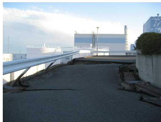
ひび割れて通行不可になった構内道路
