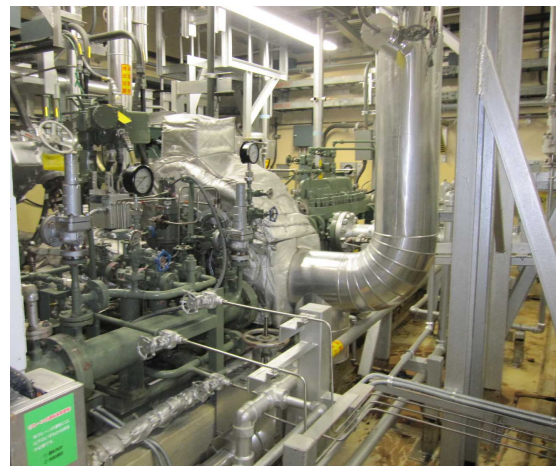
RCIC（5号機 照明あり）
