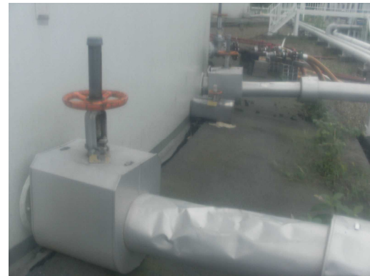
ろ過水タンク周りのタンク出口弁
