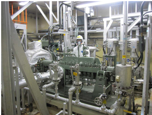
RCIC（5号機 照明あり）
