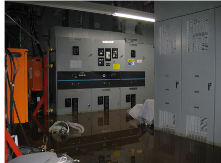
6号機電気品室の浸水状況
