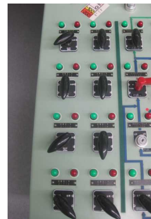
SRV 制御盤（後日撮影）
