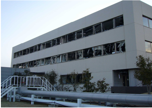
爆風により窓ガラスが割れた事務本館
