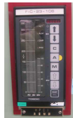
HPCI 流量制御器(FIC) (後日撮影)
