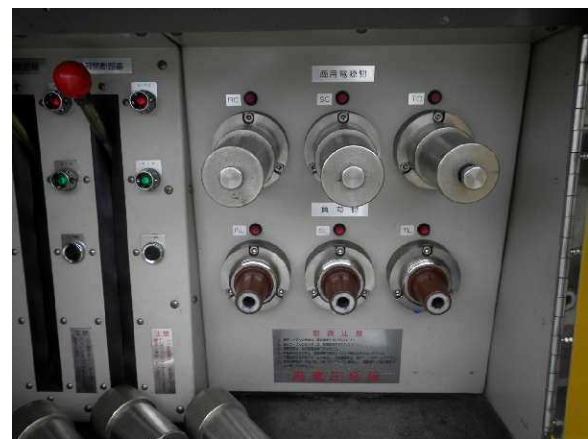
東北電力高压電源車。当社の高压電源車と同様に、P/C まで送電するためには仮設ケーブルの敷設及び端末処理が必要（後日撮影）
