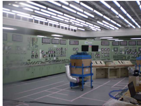
1,2号機中央制御室（後日撮影）
