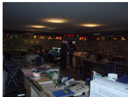
5,6号機中央制御室：5号機側 (非常灯のみ点灯している状態)
