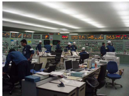
5,6号機中央制御室：6号機側
