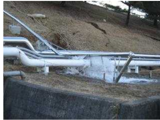
変圧器防災配管の漏えい
