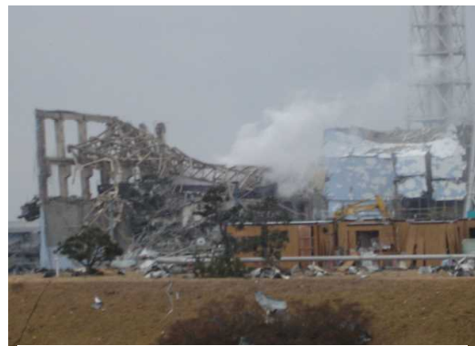
4 号機損傷状況（写真右） （写真左は 3 号機）
