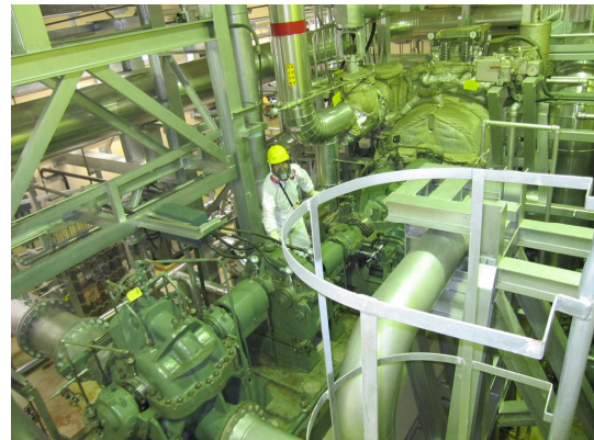
HPCI（5号機 照明あり）
