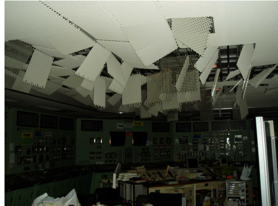
爆発後の中央制御室の状況
