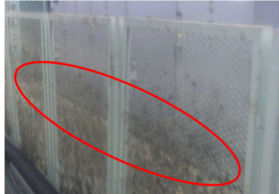
1号機タービン建屋1階 M/C の状況
