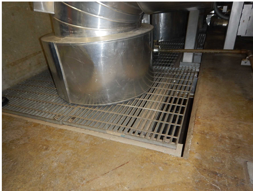
第 2.3-5 図 原子炉補機冷却海水系配管貫通部（7号炉）
