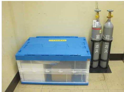
空気作動弁強制操作の資機材配備(福島第二) (圧縮空気ボンベ, 接続用ホース, 接続部品等)
