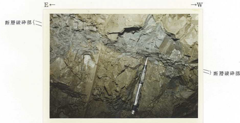
同上 接写 (F 3-3 断層)
