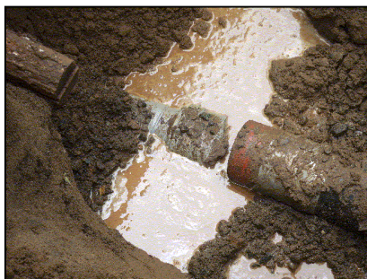
埋設消火配管の損傷
