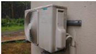
⑥-22 空調室外機
