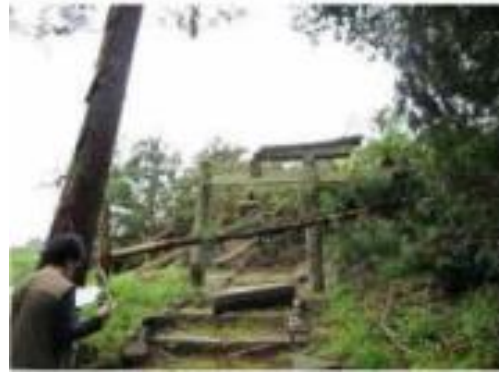
倒木の折損と鳥居の被害
