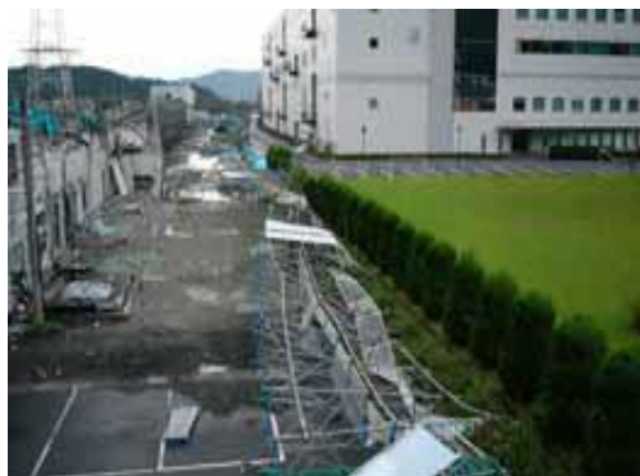
仮設足場の倒壊
