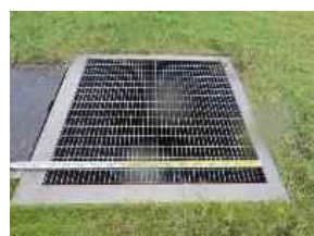
③-6 グレーチング
