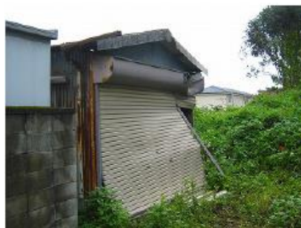
シャッターの外れ
