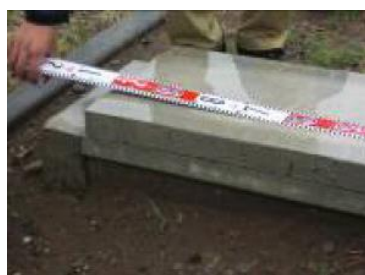
①-5 送水用配管蓋
