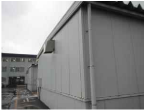
④-22 換気フード
