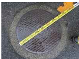
④-1 マンホール蓋
