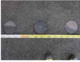
④-16 排水溝蓋
