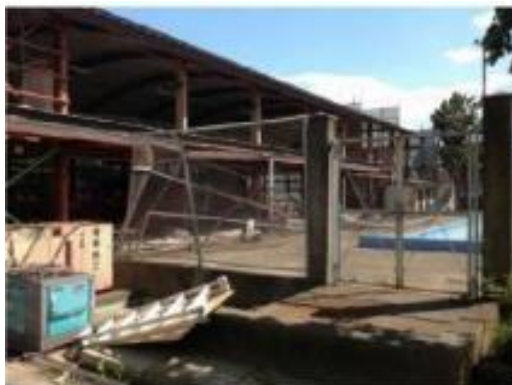
フェンスの被害（工事中の建築物）
