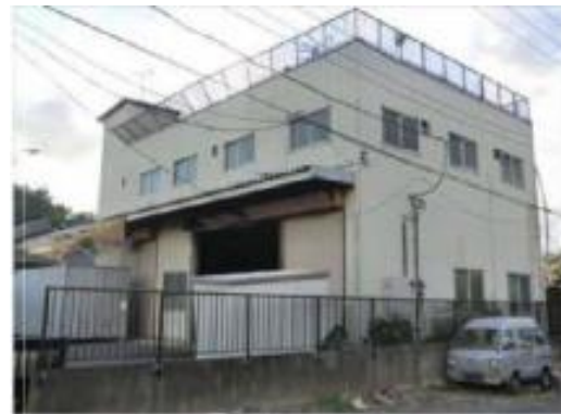
屋上フェンスの被害
