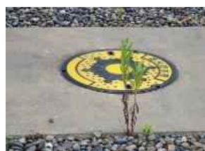
⑤-13 マンホール蓋
