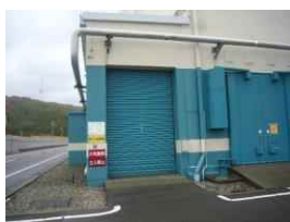
①-23 シャッター, 配管
