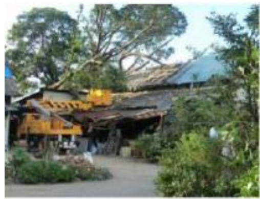
樹木の倒壊による小屋組の被害
