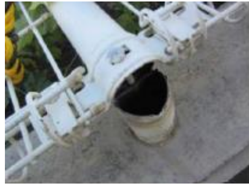
支柱部の破断
