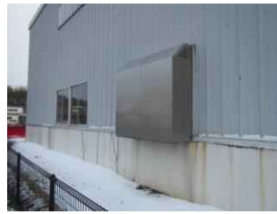
④-20 換気フード
