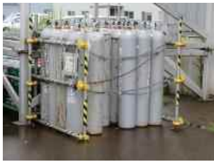
④-49 ガスボンベ
