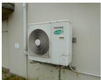
⑦-4 空調室外機
