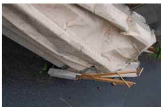
飛散した折板屋根の状況
