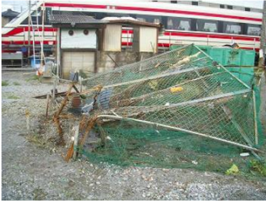
フェンスの著しい変形
