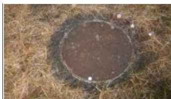
⑥-2 マンホール蓋
