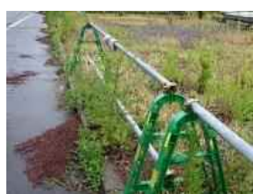
⑤-4 鋼製車止め （単管バリケード）
