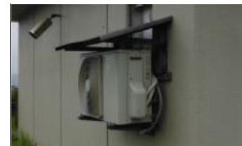
⑥-27 空調室外機
