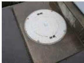
④-56 マンホール蓋
