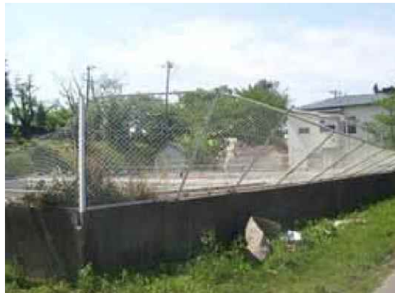
フェンスの被害状況
