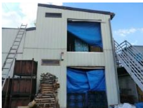
シャッターの被害
