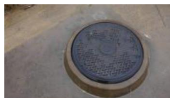
⑥-15 マンホール蓋
