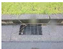
③-8 グレーチング
