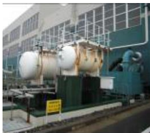
①-31 鋼製タンク
