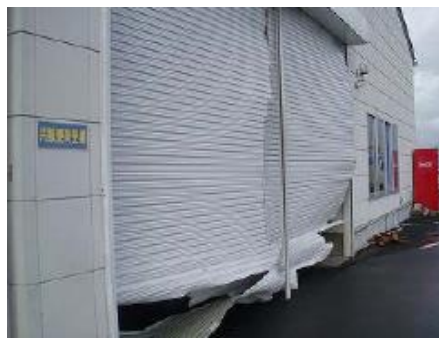
シャッターの破損
