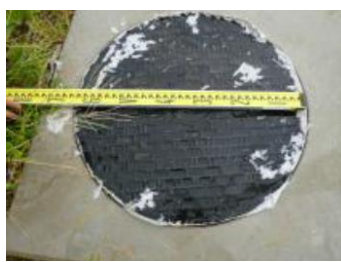
⑦-2 マンホール蓋
