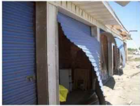
図 6 平成 20 年 5 月 25 日米国アイオワ州にて発生した EF5 竜巻によるシャッター被害状況 (6)
