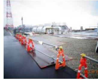
⑦-18 鋼製車止め (単管バリケード)
