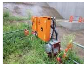
③-3 仮設分電盤
