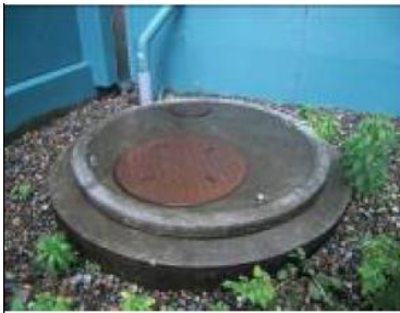
①-16 マンホール蓋
