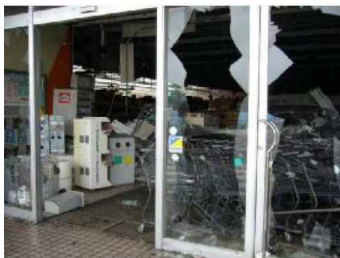
エントランスの窓ガラスの破損
