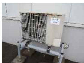
④-14 空調室外機
