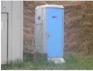
③-46 仮設トイレ
