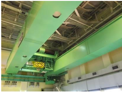
原子炉建屋クレーン外観
