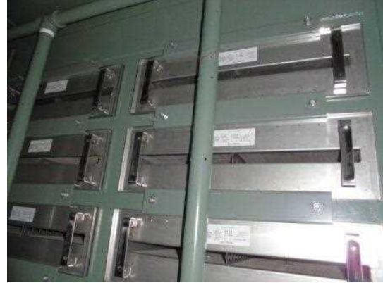
(活性炭フィルタの取付け状態)
