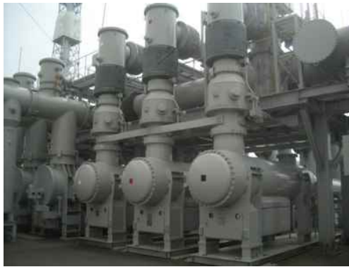
ガス絶縁開閉装置（500kV，66kV）
