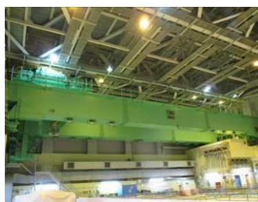
原子炉建屋クレーン
