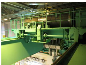
原子炉建屋クレーン外観
