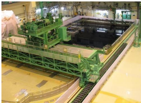
原子炉建屋運転床上設備
