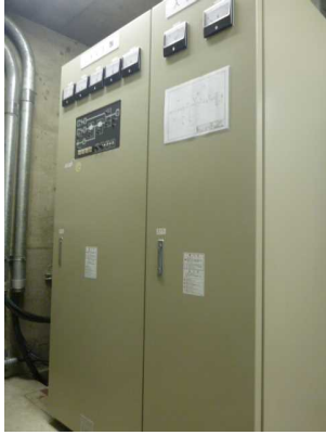
(無停電電源装置の写真)
