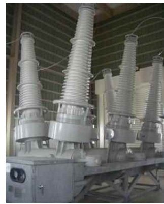
ガス遮断器（154kV）
