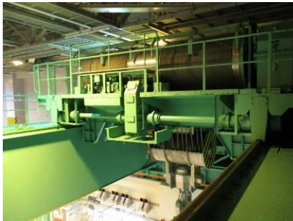
原子炉建屋クレーン外観
