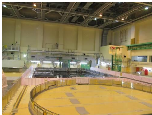
原子炉建屋運転床上設備
