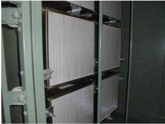
(高性能フィルタの取付け状態)
