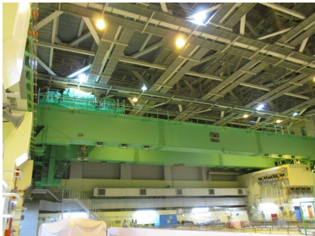
原子炉建屋クレーン外観
