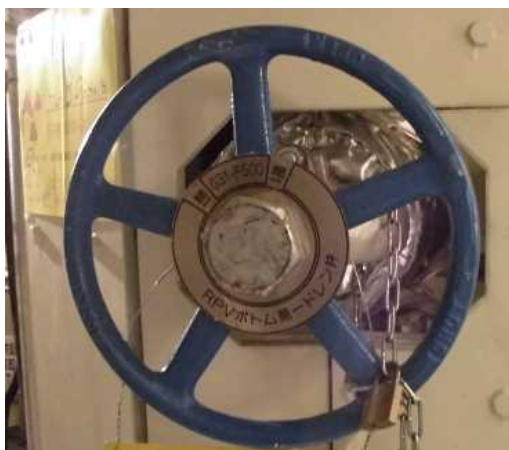
KK6原子炉圧力容器ドレン弁
