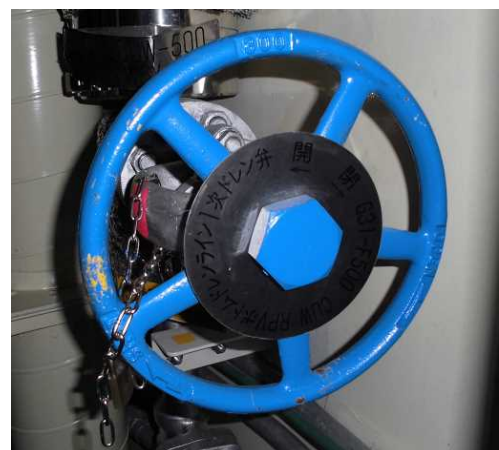
KK7原子炉圧力容器ドレン弁
