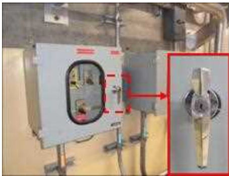
制御盤の施錠
