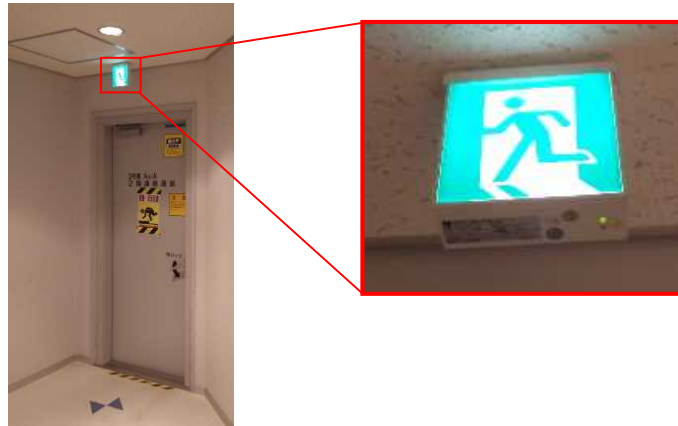
避難口誘導灯
