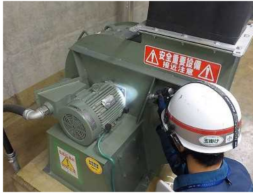
空調機起動状態確認
