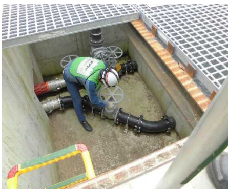
送水ホース接続部
