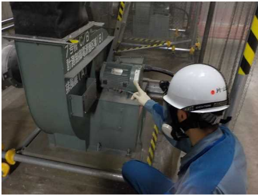
空調機運転状態確認
