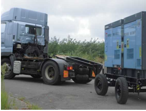
仮設発電機移動
