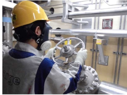
復水移送ポンプ吸込ライン切替
