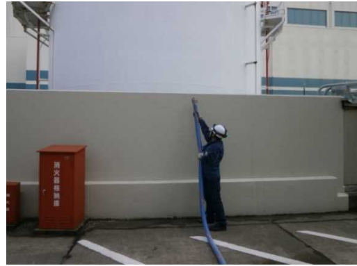
軽油タンクへのホース接続
