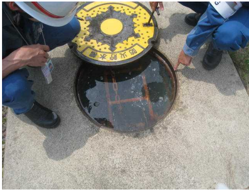
防火水槽マンホール
