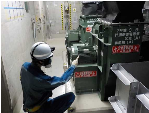
空調機運転状態確認
