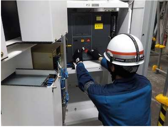
蓄電池遮断器手動開放
