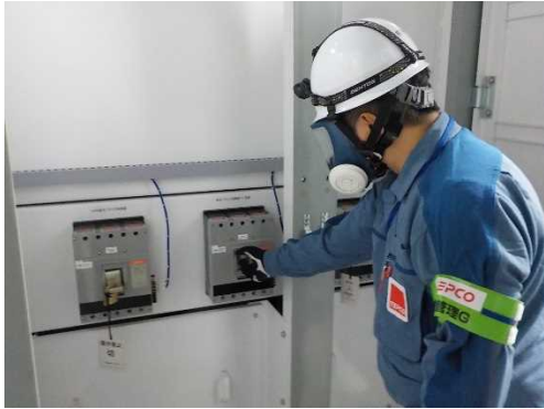
同時投入防止用盤切替盤
