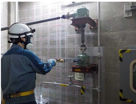
ベント操作(遠隔手動弁操作設備)
