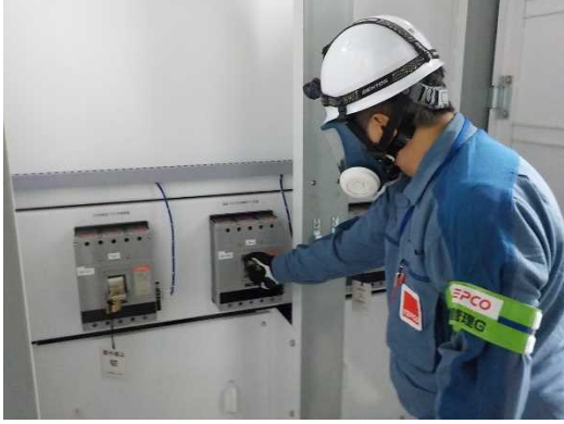
受電操作(同時投入防止用切替盤)
