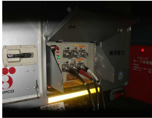
高圧ケーブル接続箇所(電源車)
