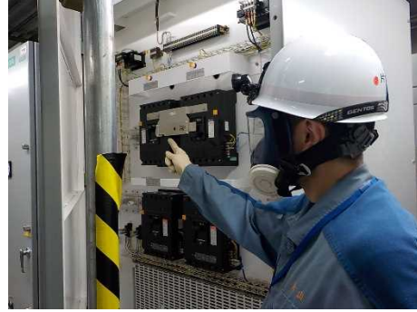
計器電源復旧(D系)
