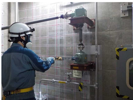
ベント操作(遠隔手動弁操作設備)
