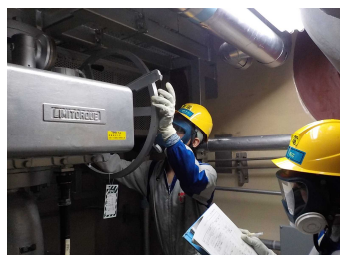
高圧代替注水系 起動操作
