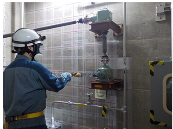
ベント操作(遠隔手動弁操作設備)
