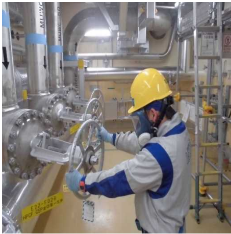
復水貯蔵槽出口ライン隔離
