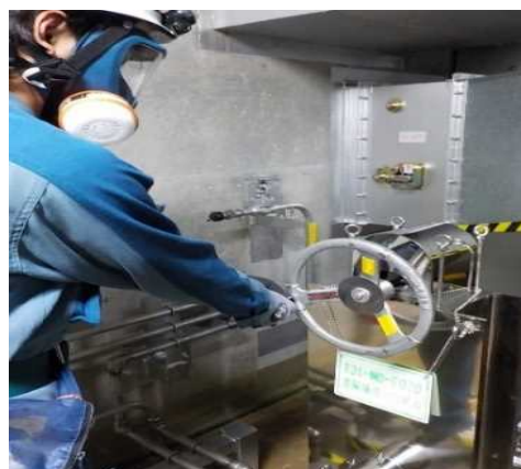
ベント操作(遠隔手動弁操作設備)
