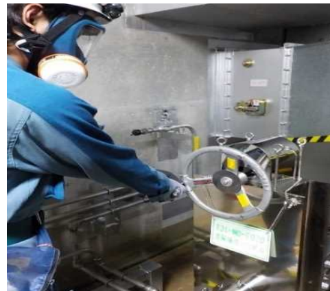
ベント操作(遠隔手動弁操作設備)
