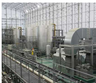
処理水タンク・供給タンクエリア
