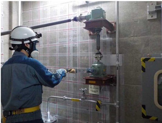
ベント操作(遠隔手動弁操作設備)
