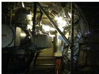
原子炉隔離時冷却系 起動操作
