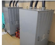
照明用変圧器
