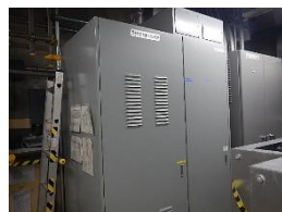
原子炉系多重伝送現場盤
