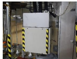
電気ペネトレーション
