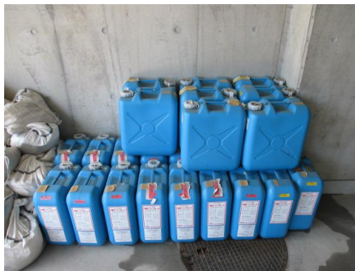
図4 泡消火薬剤ポリタンク
