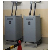
照明用変圧器
