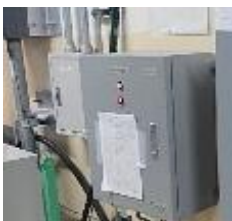
接続箱，作業用電源箱
