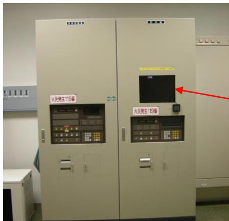
〈火災受信機盤・防災盤〉
