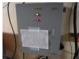
作業用電源箱
