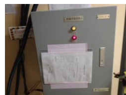
作業用電源箱
