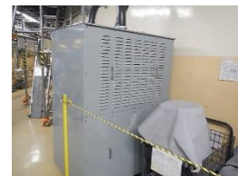
ヒータ用変圧器
