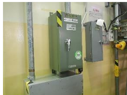
作業用電源箱
