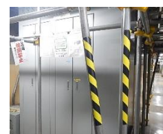
原子炉系多重伝送現場盤
