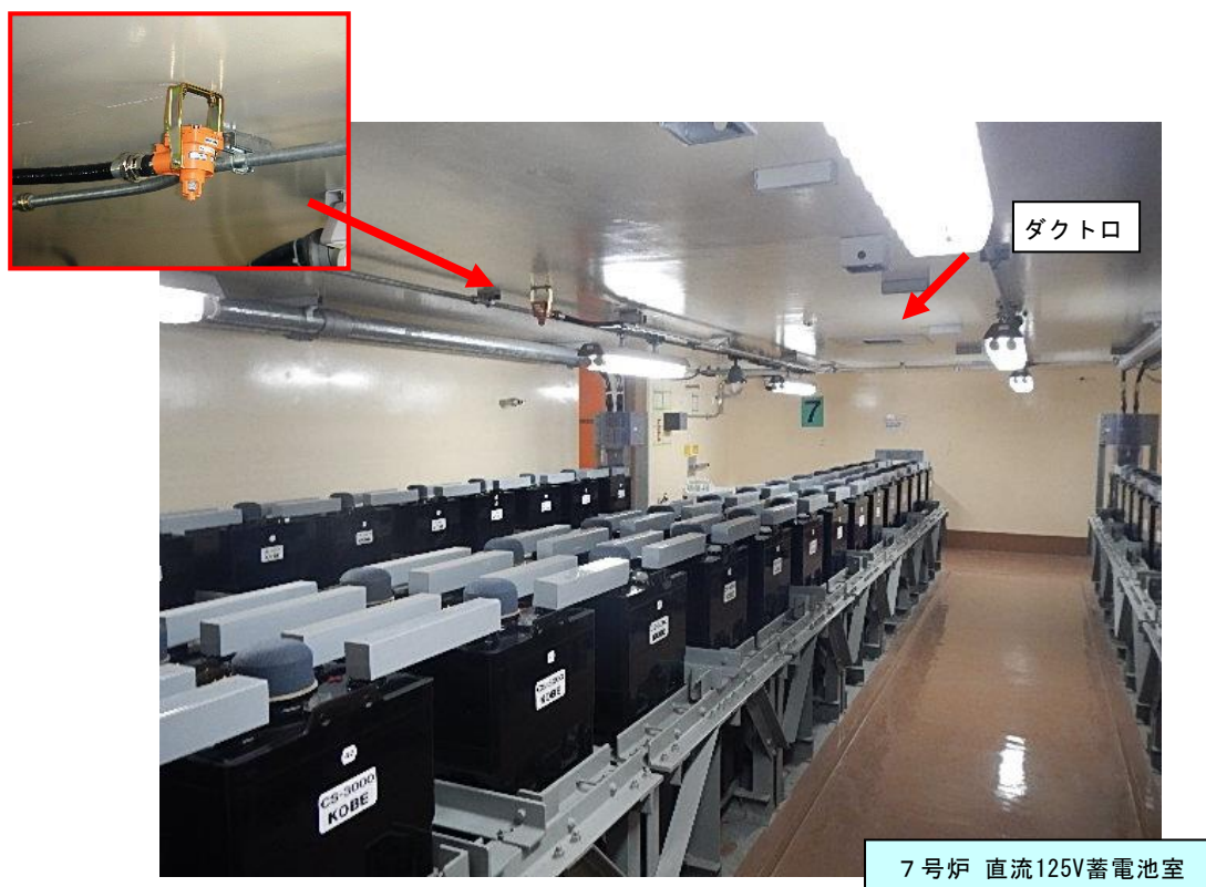
図 1-7：蓄電池室内の水素濃度検出器設置状況
