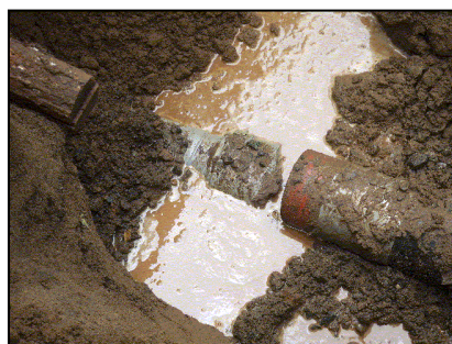
埋設消火配管の損傷
