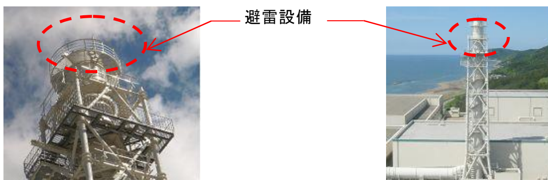
図 1-16：避雷設備の設置例（排気筒）
