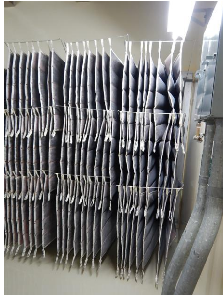
図 1-15：6号炉原子炉建屋3階 非常用ディーゼル発電機(B) エアフィルタ室の概要
