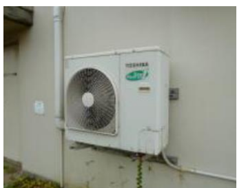
⑦-4 空調室外機
