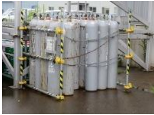
④-49 ガスボンベ
