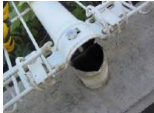
支柱部の破断
