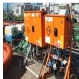
①-6 仮設分電盤
