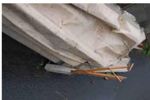
飛散した折板屋根の状況
