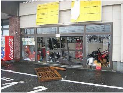
エントランスのガラス破損
