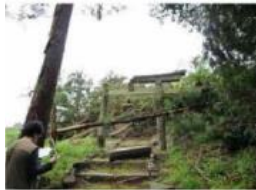
倒木の折損と鳥居の被害
