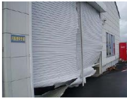
シャッターの破損
