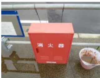
⑦-28 消火器箱 (大)
