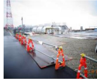
⑦-18 鋼製車止め (単管バリケード)
