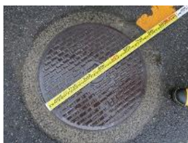
④-1 マンホール蓋
