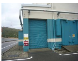
①-23 シャッター, 配管
