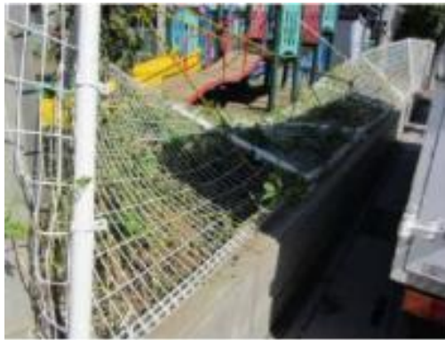
フェンスの倒壊
