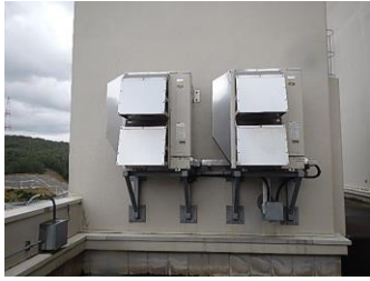
①-13 空調室外機
