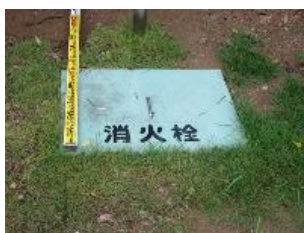
③-10 消火栓蓋
