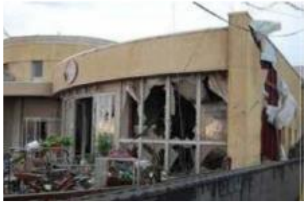
店舗の窓ガラスの被害状況
