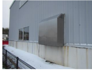
④-20 換気フード
