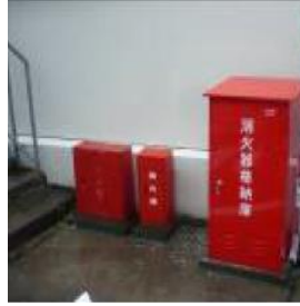
①-14 消火器箱 (小), (大)
