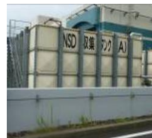
①-24 FRP タンク (FRP=繊維強化プラスチック)
