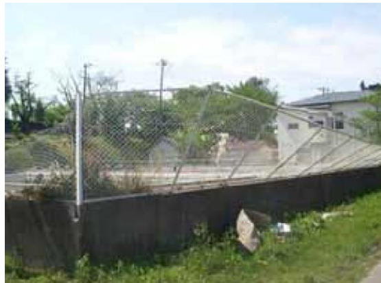
フェンスの被害状況
