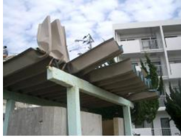
屋外トイレ屋根の損傷
