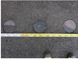
④-16 排水溝蓋
