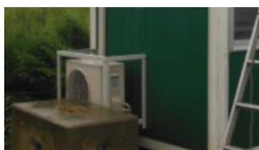
⑥-13 空調室外機
