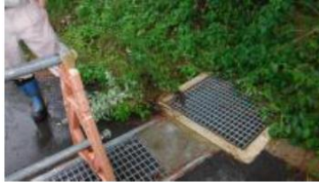
⑥-16 グレーチング
