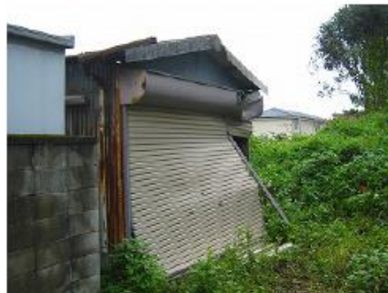
シャッターの外れ
