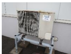
④-14 空調室外機
