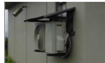
⑥-27 空調室外機
