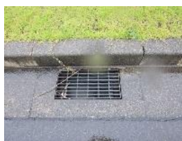
③-8 グレーチング
