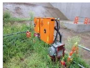
③-3 仮設分電盤
