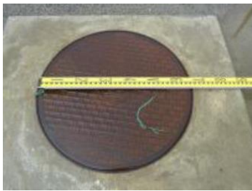
⑦-22 マンホール蓋
