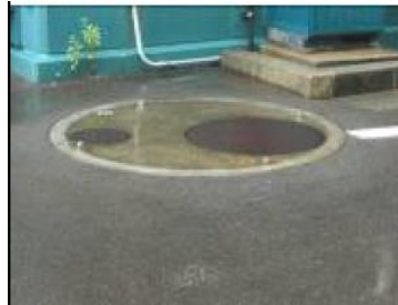
①-17 マンホール蓋
