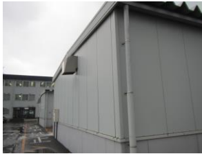
④-22 換気フード
