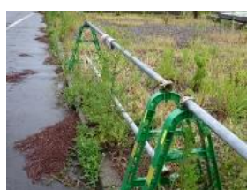
⑤-4 鋼製車止め (単管バリケード)
