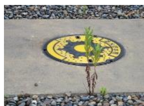
⑤-13 マンホール蓋
