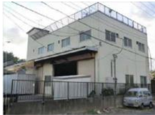
屋上フェンスの被害
