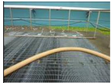
①-18 グレーチング
