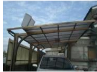
カーボード屋根の破損
