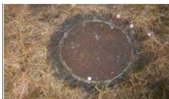
⑥-2 マンホール蓋
