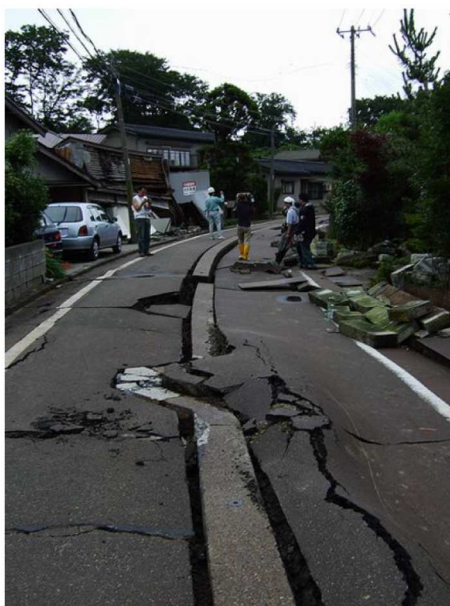
第 11.5.6 図 旧日月湖跡の道路被害 （土木学会（2010））
