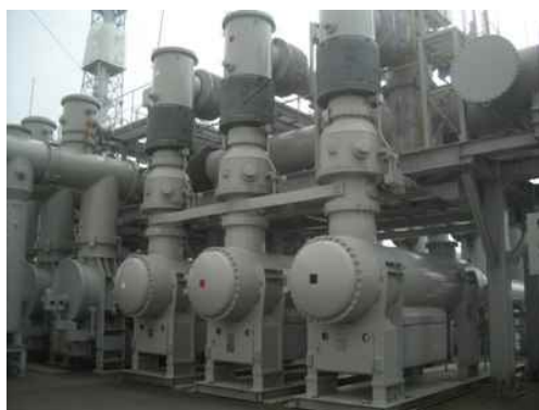
ガス絶縁開閉装置（500kV，66kV） 第2.2.4-8図 開閉所設備外観
