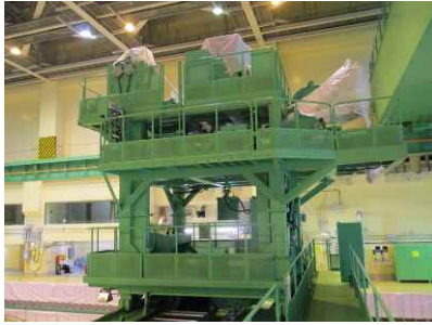
燃料取替機（トロリ）外観
