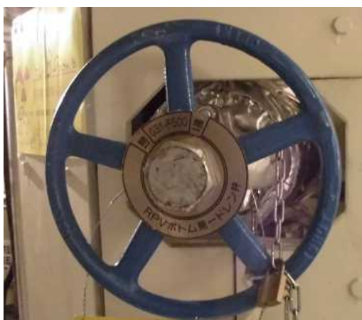
KK6原子炉圧力容器ドレン弁
