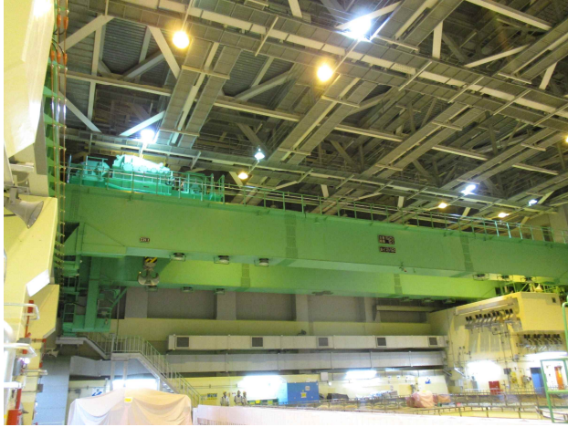
原子炉建屋クレーン外観
