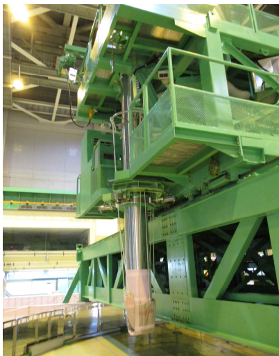
燃料取替機（トロリ）外観
