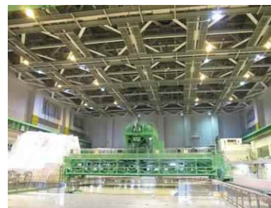
使用済燃料プール天井
