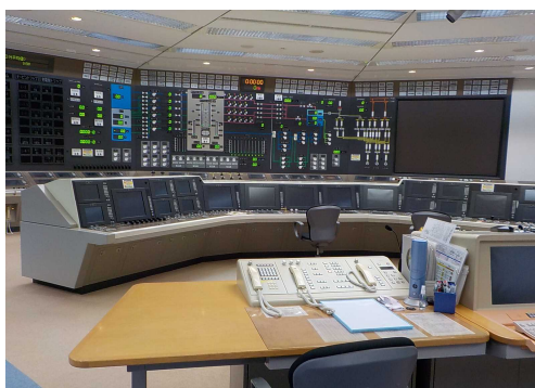
(通常点灯状態)
