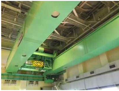
原子炉建屋クレーン外観
