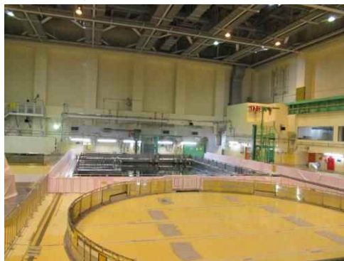
原子炉建屋運転床上設備
