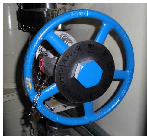
KK7原子炉圧力容器ドレン弁
