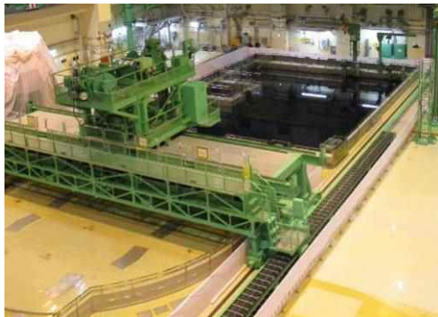
原子炉建屋運転床上設備
