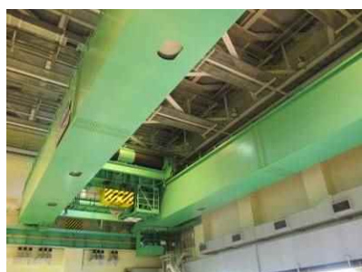
原子炉建屋クレーン
