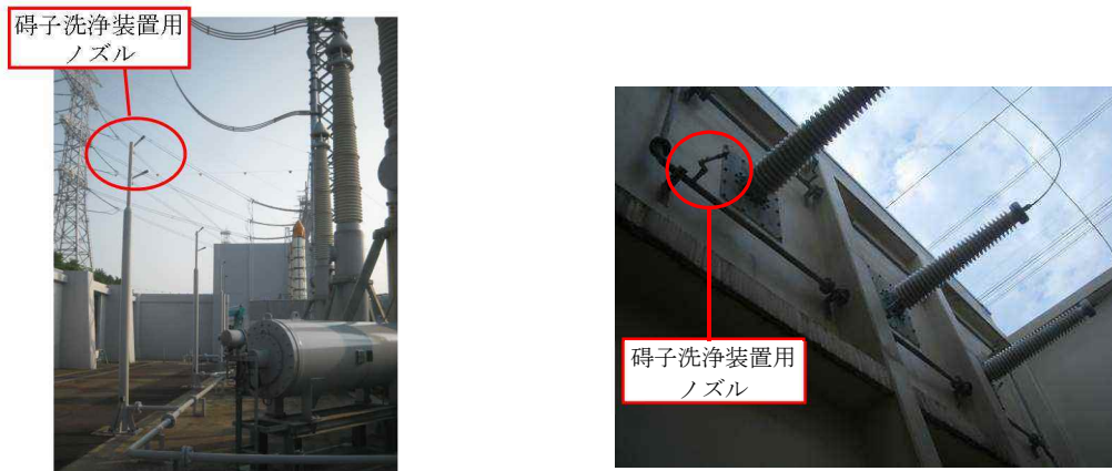
500kV 送電線（開閉所出口）
