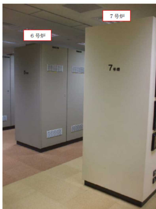
第 2.4.3-2 図 制御盤（裏盤）の色別管理
