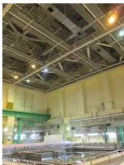
使用済燃料プール天井
