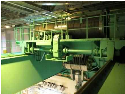
原子炉建屋クレーン外観
