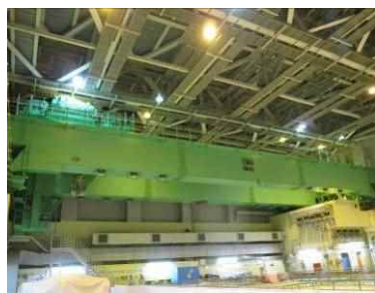
原子炉建屋クレーン
