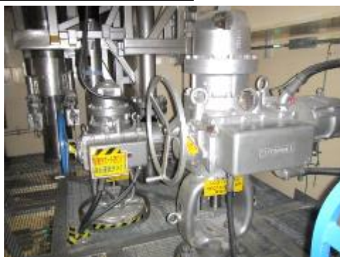
電動弁及び可とう電線管
