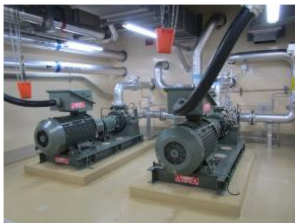
ポンプ及び可とう電線管
