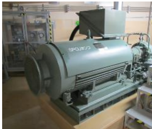
ポンプ及び可とう電線管
