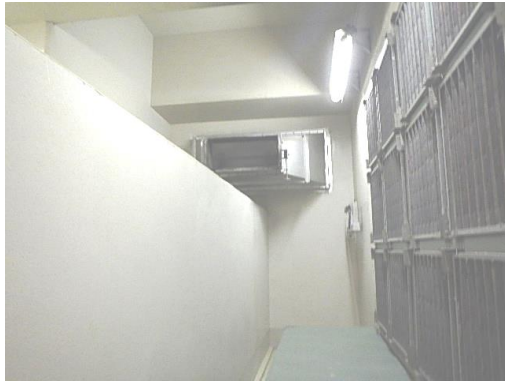
非常用ディーゼル発電機電気品区域 非常用給気処理装置室
