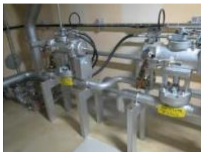
電動弁及び可とう電線管
