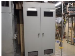
RIP取扱装置現場伝送盤
