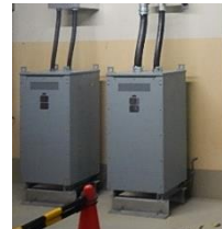
照明用変圧器
