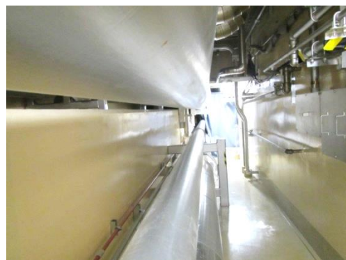
配管及び電線管
