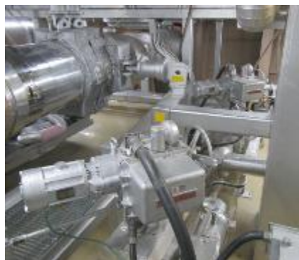
電動弁及び可とう電線管
