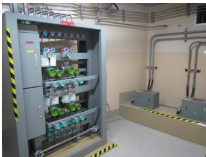
計装ラック及び地震観測装置
