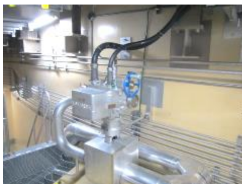
電動弁及び可とう電線管
