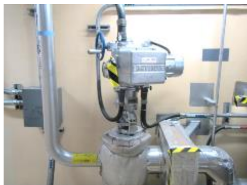
電動弁及び可とう電線管
