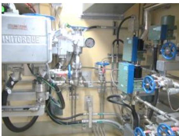
電動弁，電磁弁及び可とう電線管
