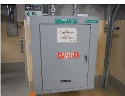
SRNM 前置増幅器盤
