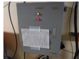
作業用電源箱
