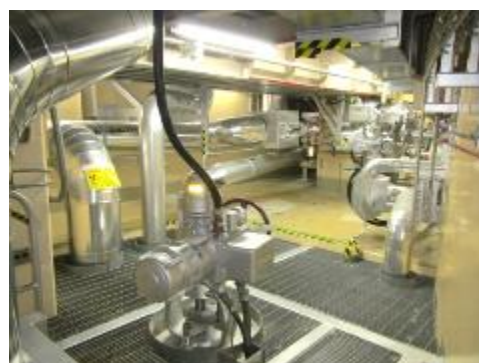
電動弁及び可とう電線管
