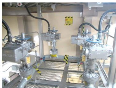
電動弁及び可とう電線管
