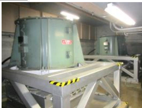
非常用送風機
