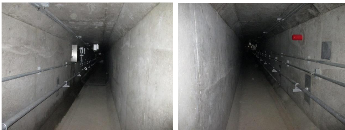
配管及び電線管
