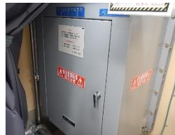
SRNM 前置増幅器盤
