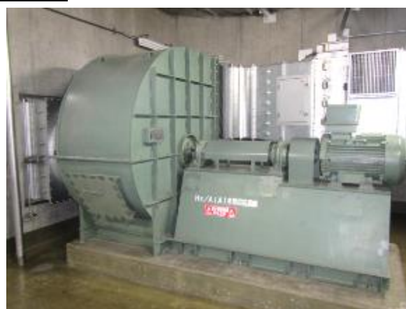
送風機及び電動機
