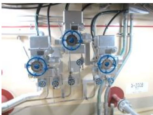
電動弁及び可とう電線管
