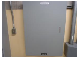
通信設備用分岐箱
