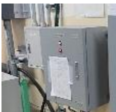
接続箱，作業用電源箱
