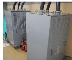
照明用変圧器
