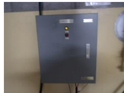
作業用電源箱
