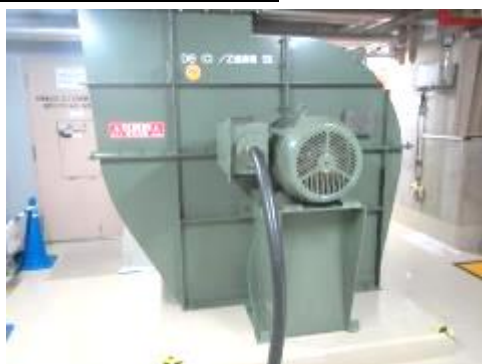
電動機及び可とう電線管
