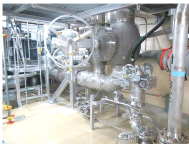
電動弁及び可とう電線管
