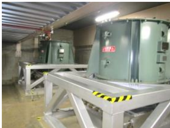
非常用送風機
