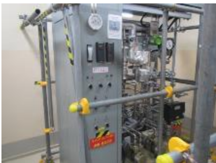
計装ラック及びサンプルポンプ
