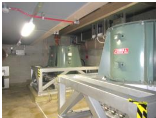
非常用送風機
