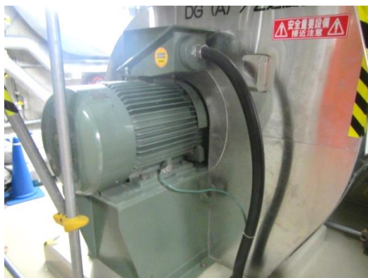
電動機及び可とう電線管
