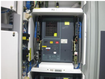
気中遮断器の例 (P/C)
