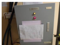
作業用電源箱
