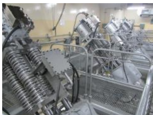
主蒸気隔離弁
