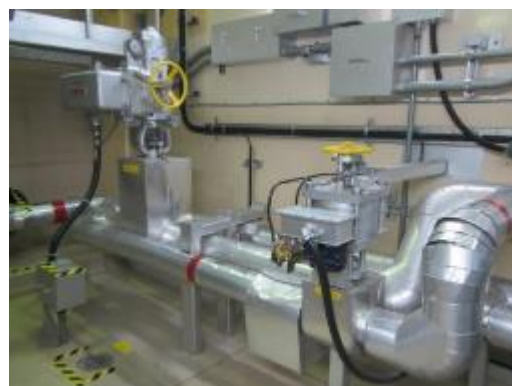
電動弁及び可とう電線管
