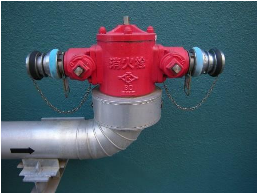
図 1-32 : 不凍式消火栓の設置状況
