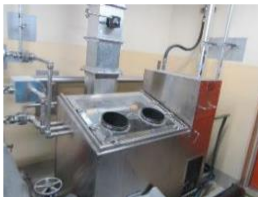
除染シンク及び可とう電線管
