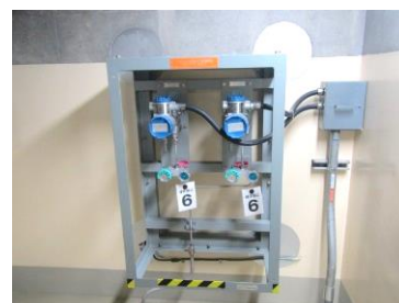
計器 (圧力検出器)
