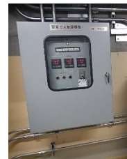
窒素ガス加温器盤
