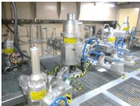
電動弁及び可とう電線管
