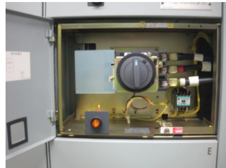
配線用遮断器の例 (MCC)
