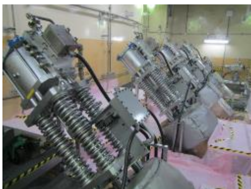
主蒸気隔離弁
