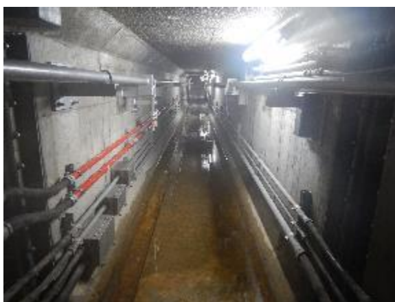
配管及び電線管
