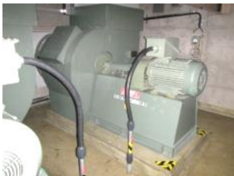
送風機，電動機及び可とう電線管
