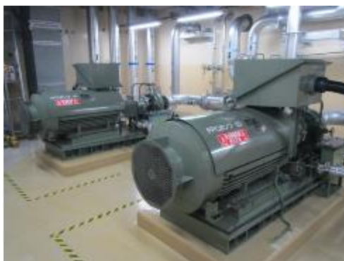
ポンプ及び可とう電線管
