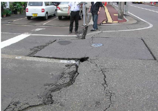
第 11.5.3 図 砂丘肩部分に現れた亀裂開口 (土木学会 (2010) に一部修正)
