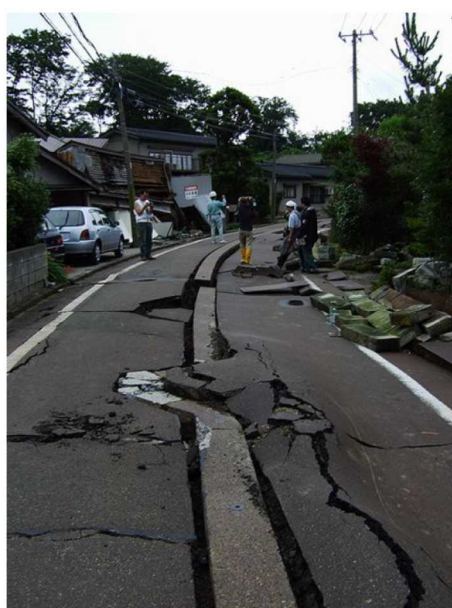
第 11-11-30 図 旧三日月湖跡の道路被害 （土木学会（2010））
