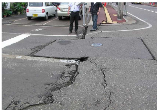
第 11-11-27 図 砂丘肩部分に現れた亀裂開口 (土木学会 (2010) に一部修正)
