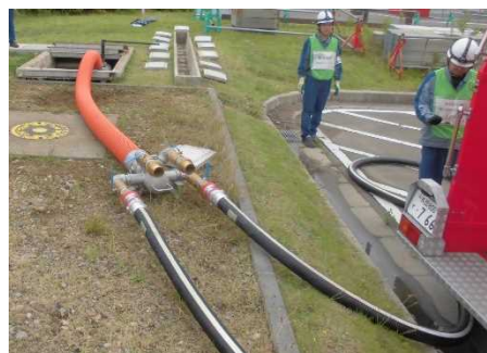
[淡水貯水池を水源とした場合] 送水ホースと可搬型代替注水ポンプ 吸管との接続
