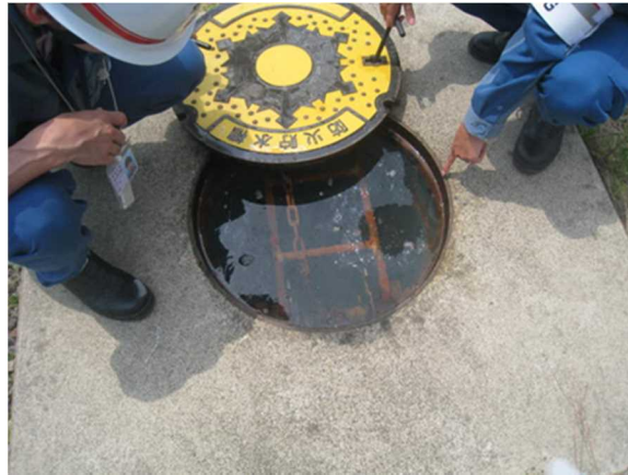
防火水槽マンホール
