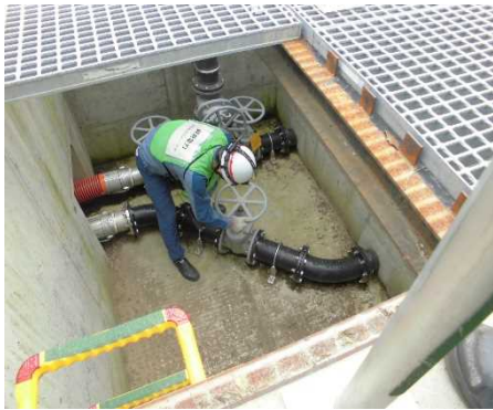
ホース接続部
