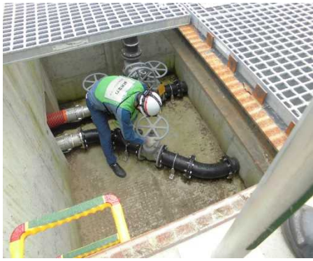
ホース接続部
