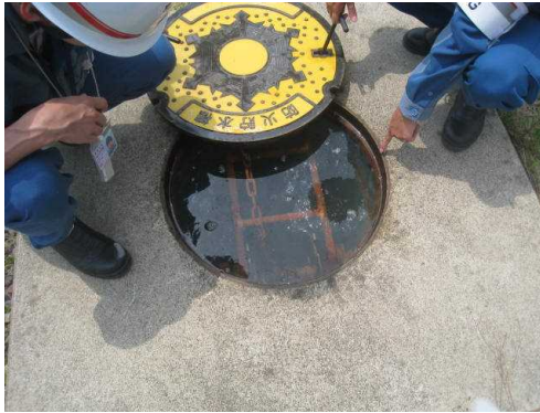
防火水槽マンホール
