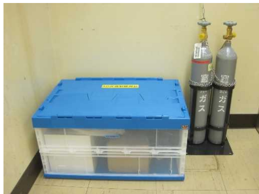
空気作動弁強制操作用の資機材配備(福島第二) (圧縮空気ボンベ, 接続用ホース, 接続部品等)
