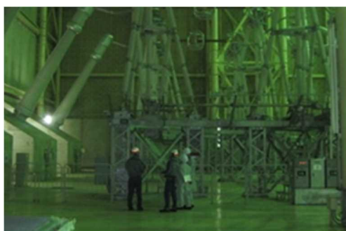
開閉所機器の確認
