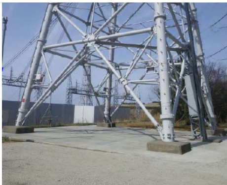
新新潟幹線 No. 1 送電鉄塔
