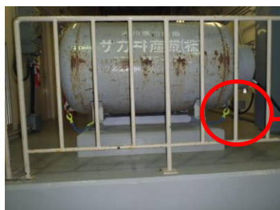
雑固体廃棄物焼却設備プロパン庫
