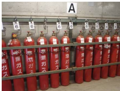
水素ボンベの固縛状況 (6号炉)
