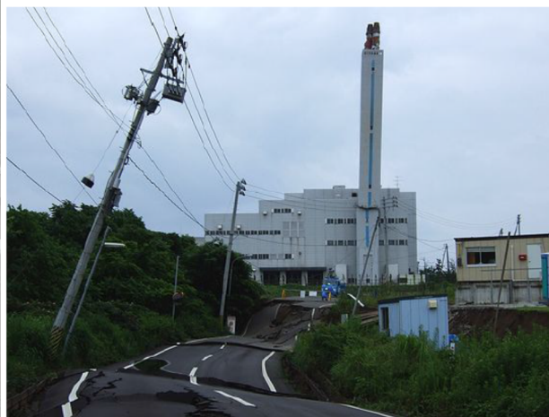
第 11-11-31 図 河道沿いの道路被害 （土木学会（2010））
