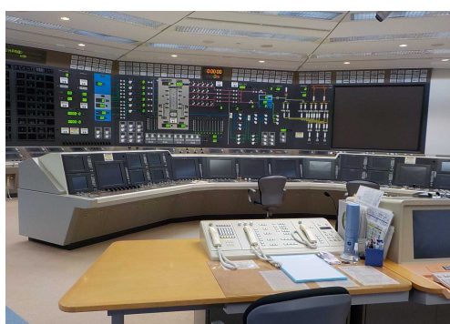
(通常点灯状態)
