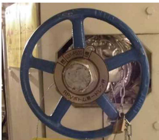
KK6原子炉圧力容器ドレン弁
