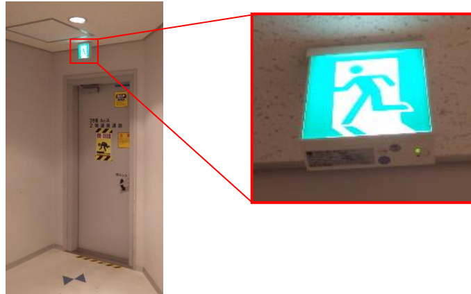
避難口誘導灯
