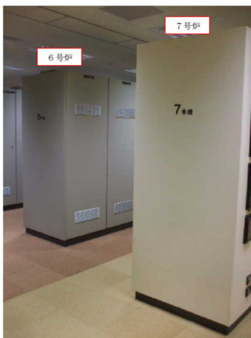
第 2.4.3-2 図 制御盤（裏盤）の色別管理
