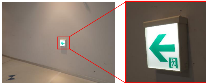
通路誘導灯（廊下・通路）
