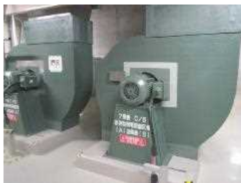
送風機、電動機及び可とう電線管
