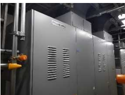
原子炉系多重伝送現場盤
