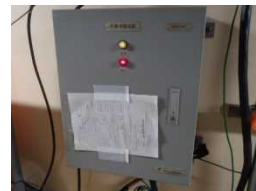
作業用電源箱
