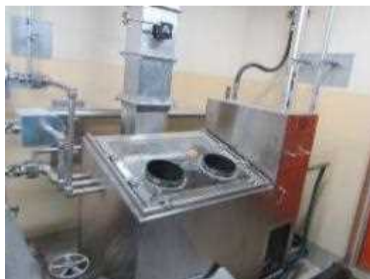
除染シンク及び可とう電線管
