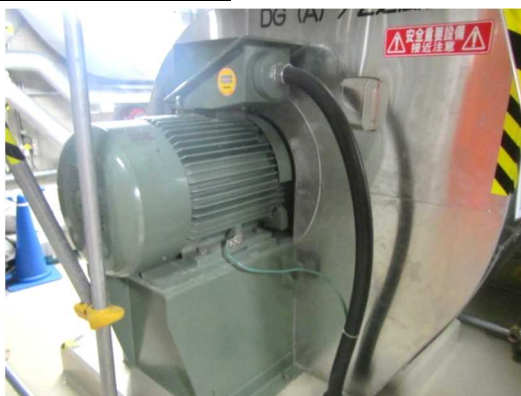
電動機及び可とう電線管
