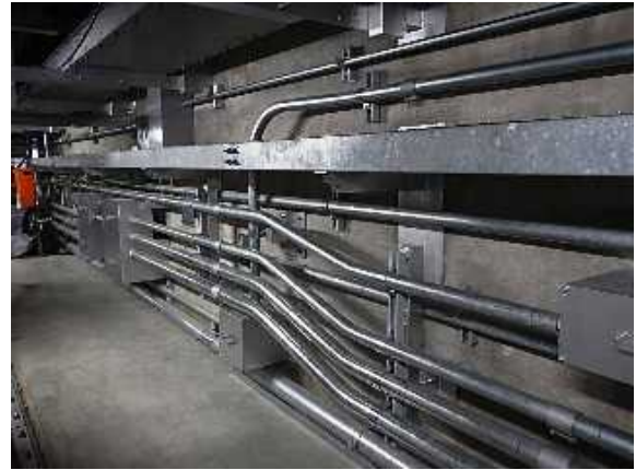
ケーブルトレイ，電線管の例
