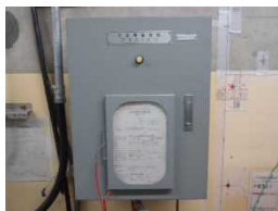
作業用電源箱
