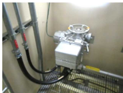
電動弁及び可とう電線管
