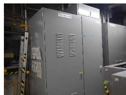
原子炉系多重伝送現場盤
