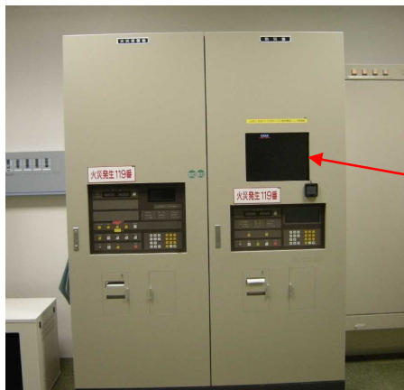
〈火災受信機盤・防災盤〉
