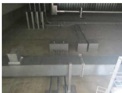
空調ダクト及び可とう電線管
