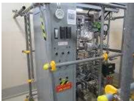
計装ラック及びサンプルポンプ
