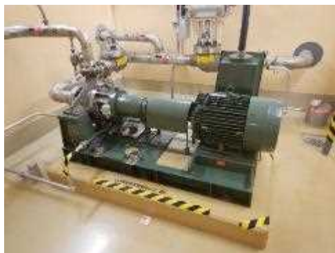
CUW 逆洗水移送ポンプ
