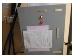
作業用電源箱
