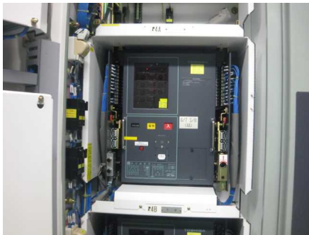
気中遮断器の例 (P/C)
