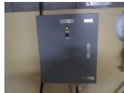
作業用電源箱
