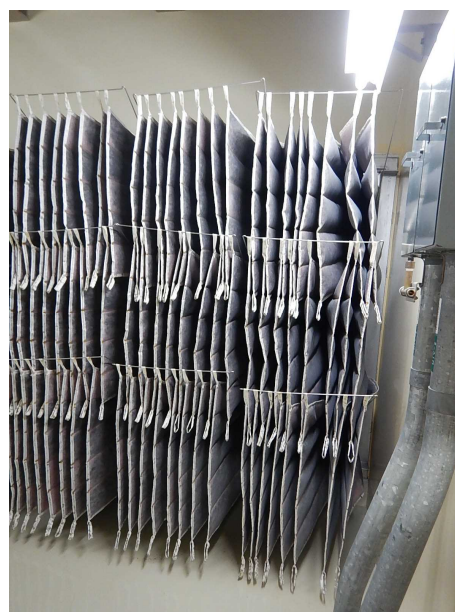
第 1-15 図：6 号炉原子炉建屋 3 階 非常用ディーゼル発電機 (B) エアフィルタ室の概要
