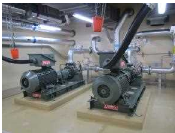
ポンプ及び可とう電線管
