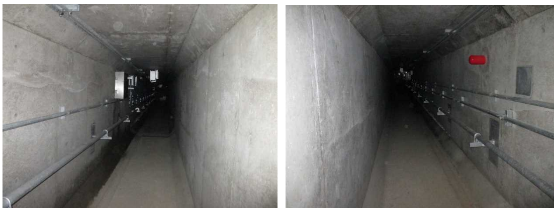
配管及び電線管
