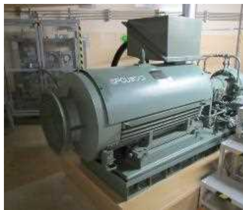
ポンプ及び可とう電線管
