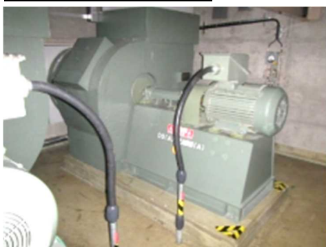
送風機、電動機及び可とう電線管
