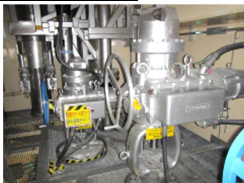
電動弁及び可とう電線管
