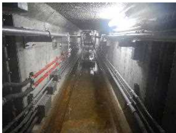
配管及び電線管
