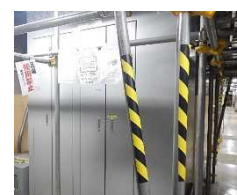
原子炉系多重伝送現場盤
