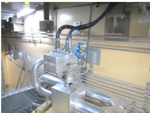
電動弁及び可とう電線管
