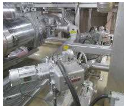
電動弁及び可とう電線管
