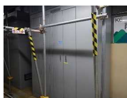
原子炉系多重伝送現場盤
