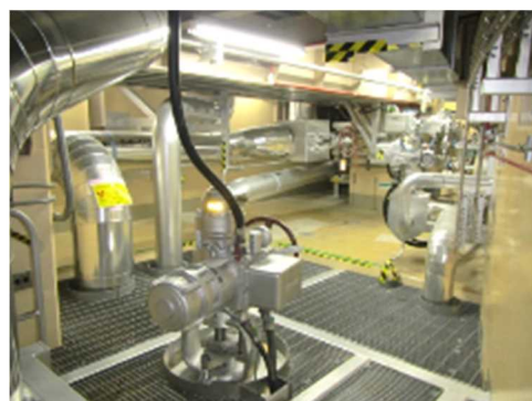
電動弁及び可とう電線管
