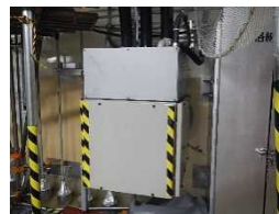
電気ペネトレーション
