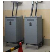
照明用変圧器
