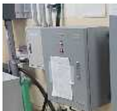
接続箱，作業用電源箱
