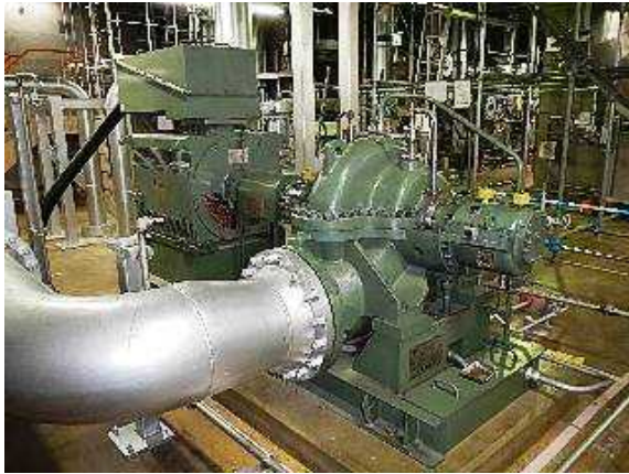
ポンプ，配管，支持構造物の例
