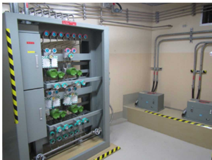
計装ラック及び地震観測装置
