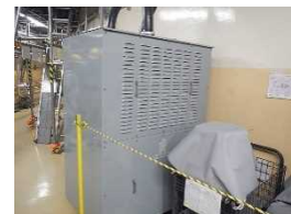
ヒータ用変圧器
