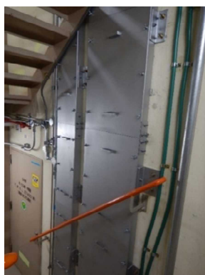
密閉型ダクト及び電線管
