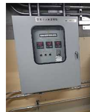
窒素ガス加温器盤
