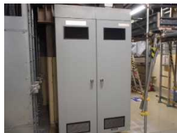
RIP取扱装置現場伝送盤
