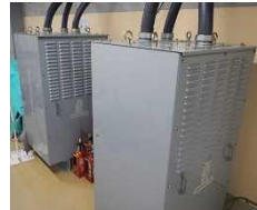
照明用変圧器
