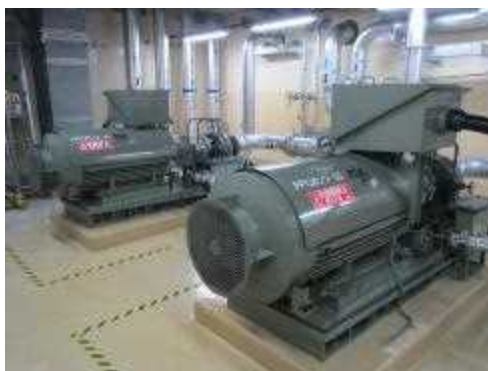
ポンプ及び可とう電線管
