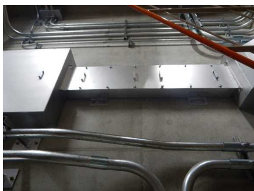
密閉型ダクト及び電線管
