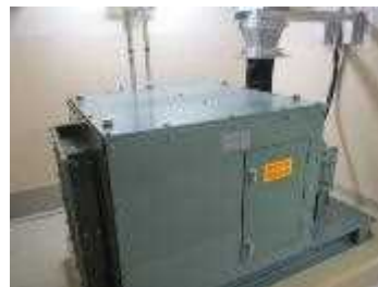
電動機及び可とう電線管
