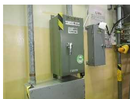
作業用電源箱
