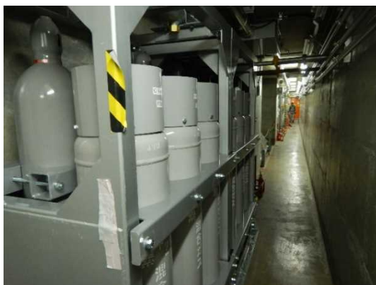
ポンベ及び配管
