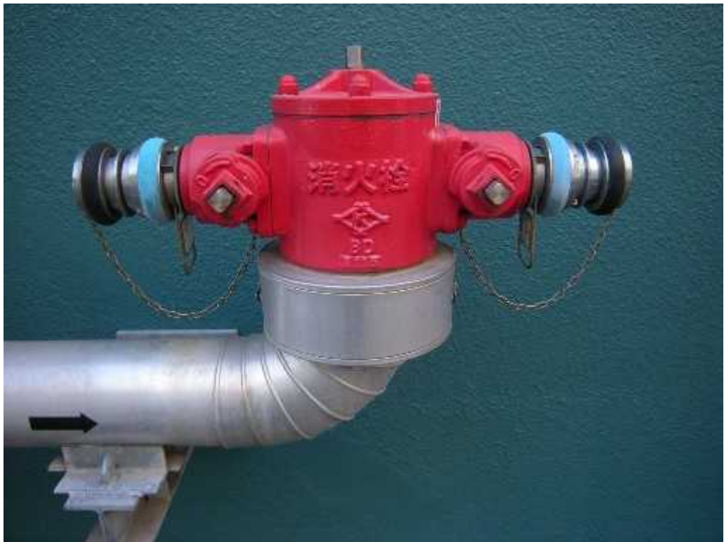
第 1-32 図：不凍式消火栓の設置状況
