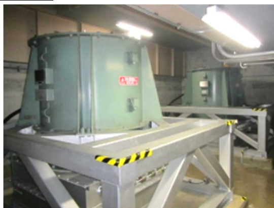
非常用送風機
