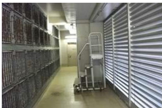
図7-1 非常用ディーゼル発電機のバグフィルタ(写真左側)
