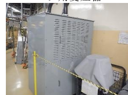
ヒータ用変圧器
