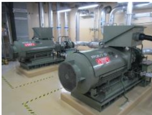
ポンプ及び可とう電線管
