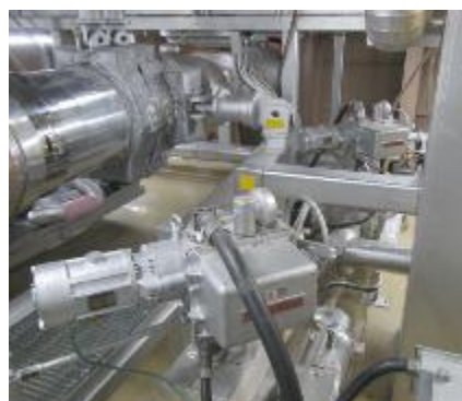
電動弁及び可とう電線管
