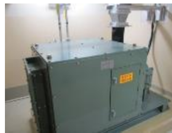
電動機及び可とう電線管
