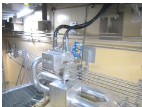
電動弁及び可とう電線管
