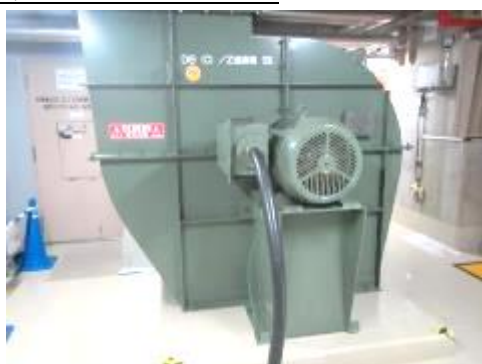
電動機及び可とう電線管
