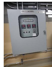
窒素ガス加温器盤
