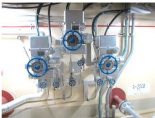
電動弁及び可とう電線管
