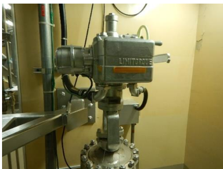
電動弁及び可とう電線管
