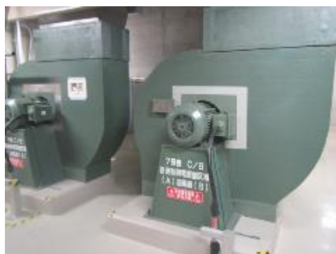
送風機、電動機及び可とう電線管
