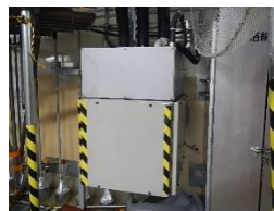
電気ペネトレーション
