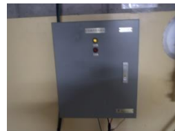
作業用電源箱
