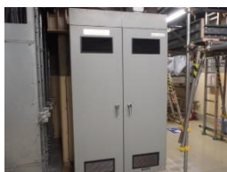
RIP取扱装置現場伝送盤
