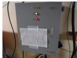
作業用電源箱
