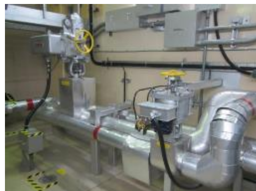
電動弁及び可とう電線管
