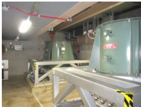
非常用送風機
