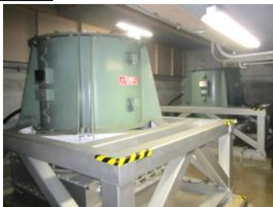
非常用送風機
