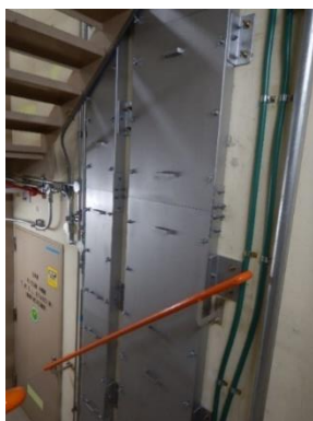
密閉型ダクト及び電線管
