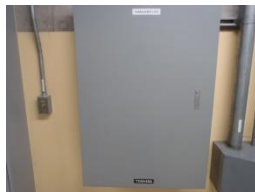
通信設備用分岐箱
