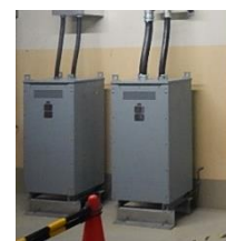
照明用変圧器
