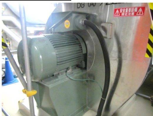
電動機及び可とう電線管
