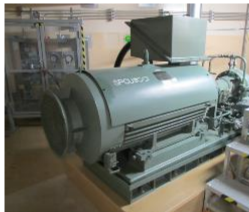
ポンプ及び可とう電線管
