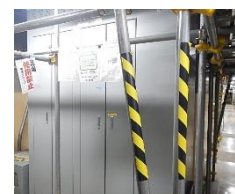
原子炉系多重伝送現場盤
