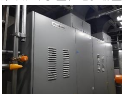
原子炉系多重伝送現場盤
