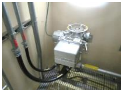
電動弁及び可とう電線管
