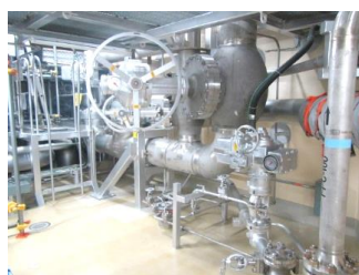
電動弁及び可とう電線管
