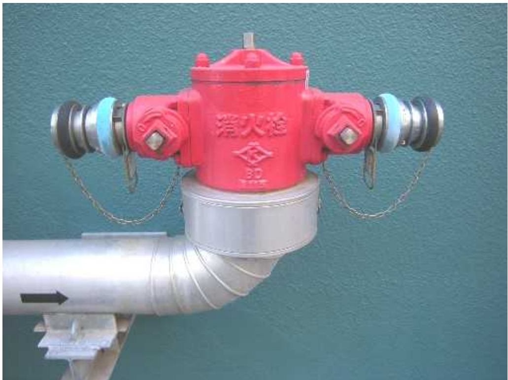
第 41-1-35 図：不凍式消火栓の設置状況
