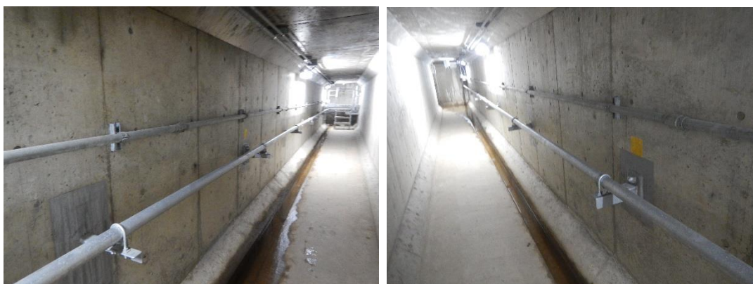
配管及び電線管
