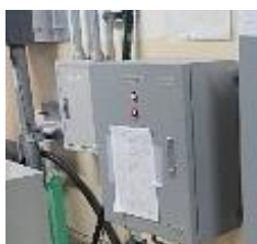
接続箱、作業用電源箱
