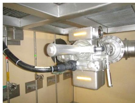
電動弁及び可とう電線管
