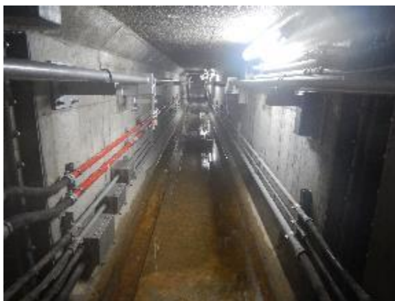
配管及び電線管
