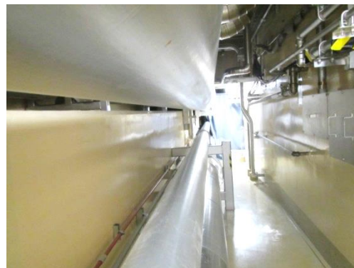
配管及び電線管
