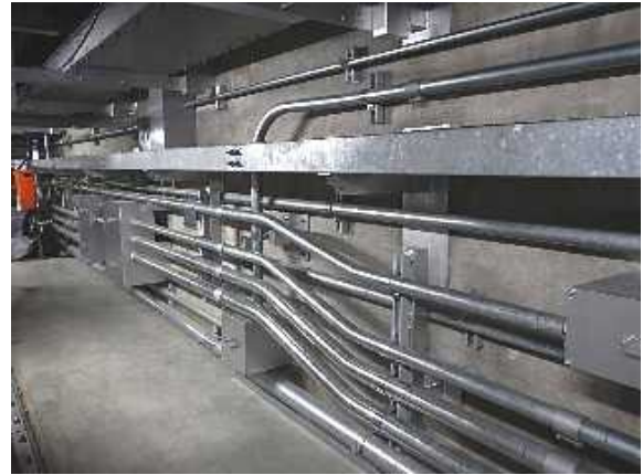
ケーブルトレイ，電線管の例
