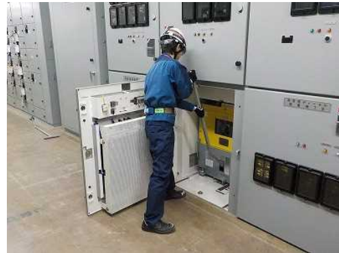
緊急用 M/C 遮断器手動投入
