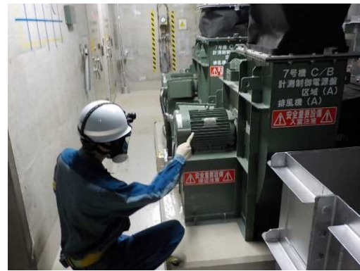
空調機運転状態確認
