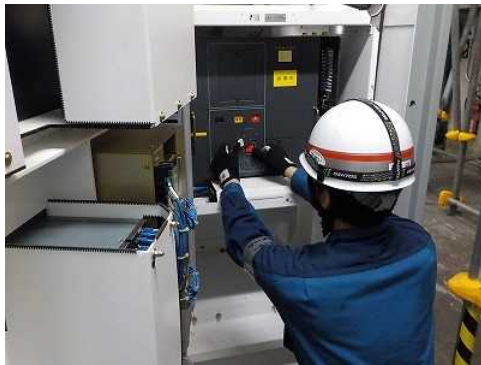
蓄電池遮断器手動開放
