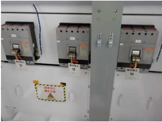
同時投入防止用切替盤
