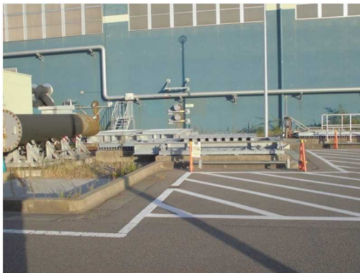
6号炉 緊急海水取水口（北側）
