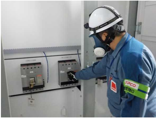
同時投入防止用切替盤
