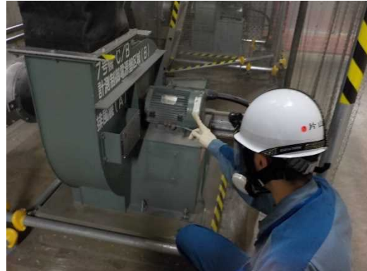
空調機運転状態確認
