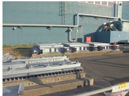
7号炉 緊急海水取水口
