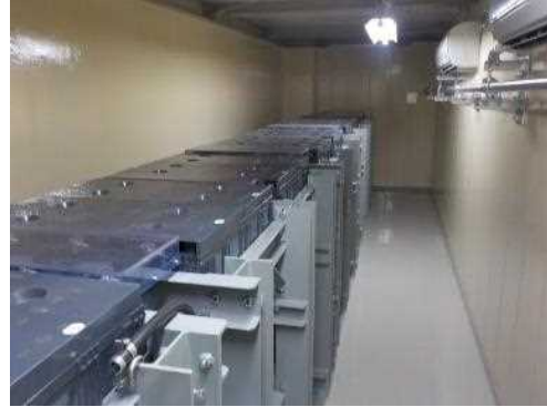
AM 用直流 125V 蓄電池
