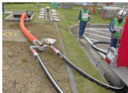
[淡水貯水池を水源とした場合] ホースと可搬型代替注水ポンプ 吸管との接続
