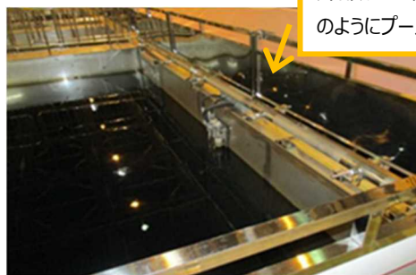
使用済燃料プール外部スプレイ設備
