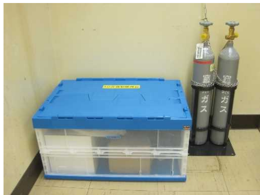
空気作動弁強制操作用の資機材配備(福島第二原子力発電所) (圧縮空気ボンベ, 接続用ホース, 接続部品等)
