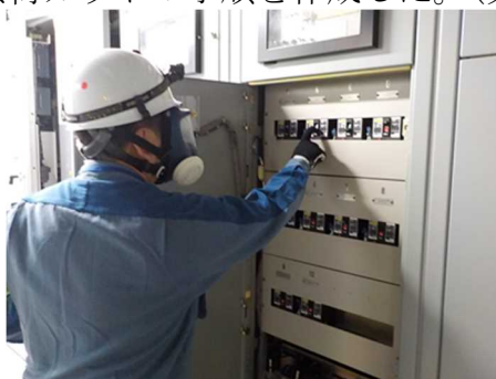
直流電源延命のための負荷カット手順に基づいた操作訓練 (柏崎刈羽原子力発電所)
