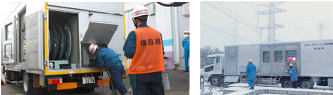
代替交流電源設備（ガスタービン発電機、電源車）の接続訓練
