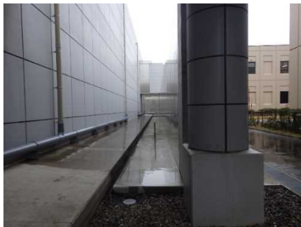
変位量識別ポールの設置状況
