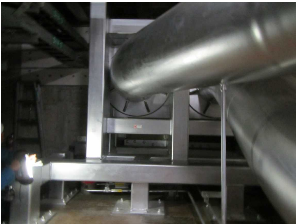
RCW (A) 配管 外観
