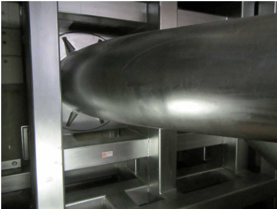
RCW (A) 配管 外観
