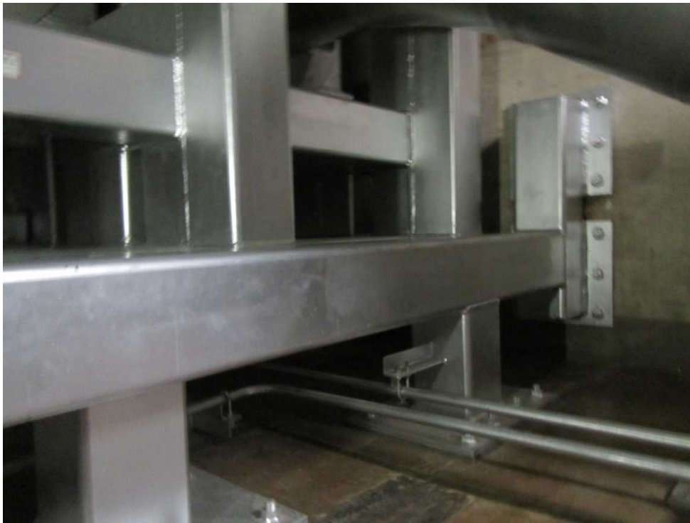
RCW (A) 配管サポート 外観
