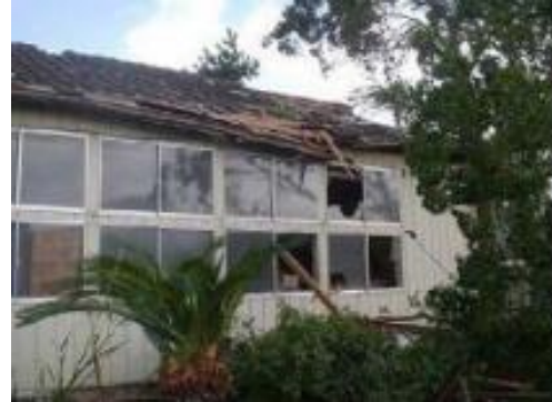
倉庫の窓ガラスと屋根の被害状況
