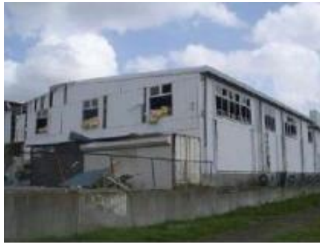
窓ガラスの破損
