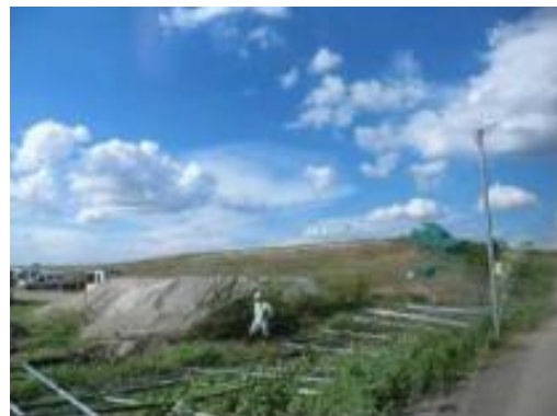
フェンスの被害
