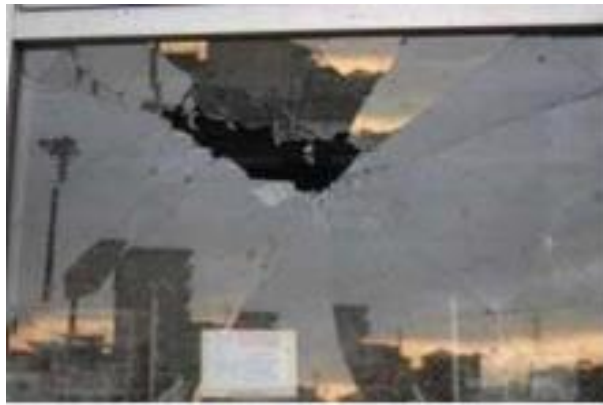
ガラスへの飛来物の衝突痕
