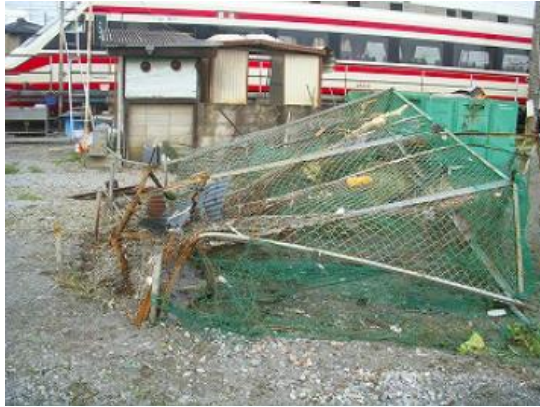
フェンスの著しい変形
