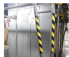
原子炉系多重伝送現場盤
