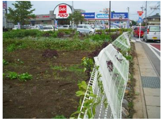
フェンスの変形
