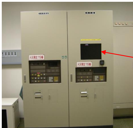
〈火災受信機盤・防災盤〉
