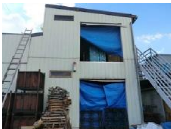
シャッターの被害
