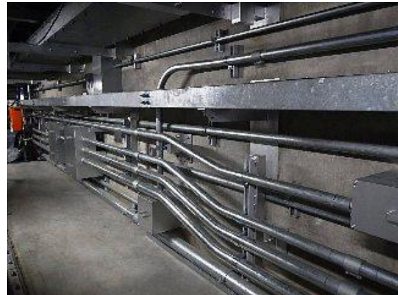
ケーブルトレイ，電線管の例
