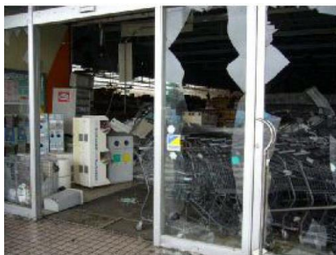
エントランスの窓ガラスの破損
