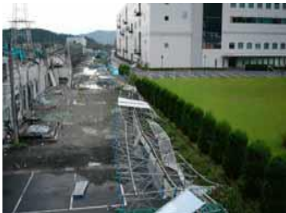
仮設足場の倒壊
