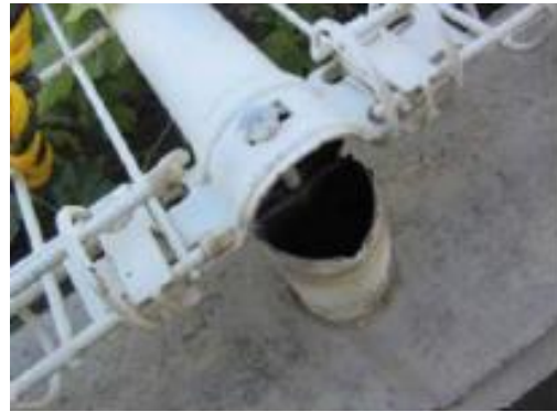
支柱部の破断
