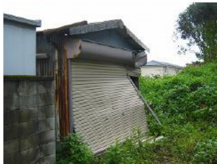
シャッターの外れ
