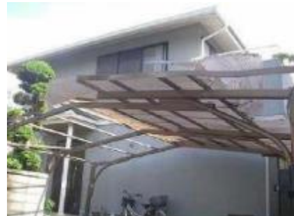
カーボードの被害
