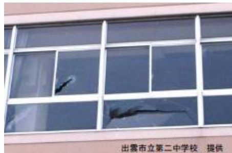
体育館窓ガラスの破損
