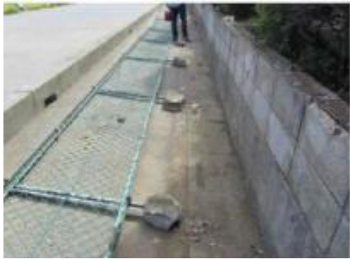
フェンスの倒壊
