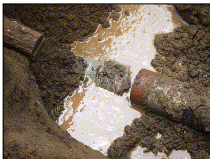
埋設消火配管の損傷
