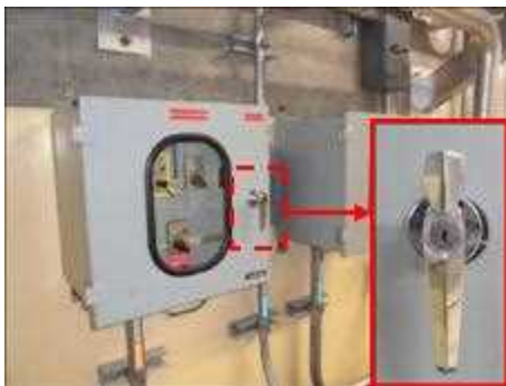
制御盤の施錠
