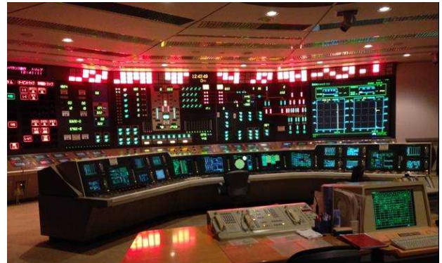
直流非常灯のみのイメージ (シミュレータ訓練において)
