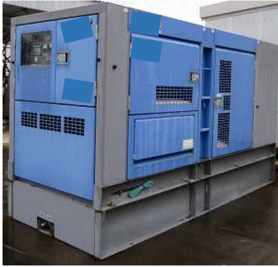
图 4-14 5号炉原子炉建屋内緊急時対策所用可搬型電源設備 外觀
