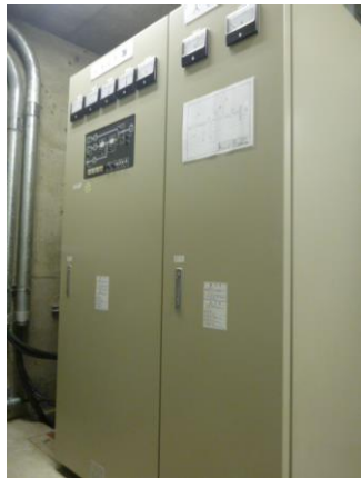
(無停電電源装置の写真)
