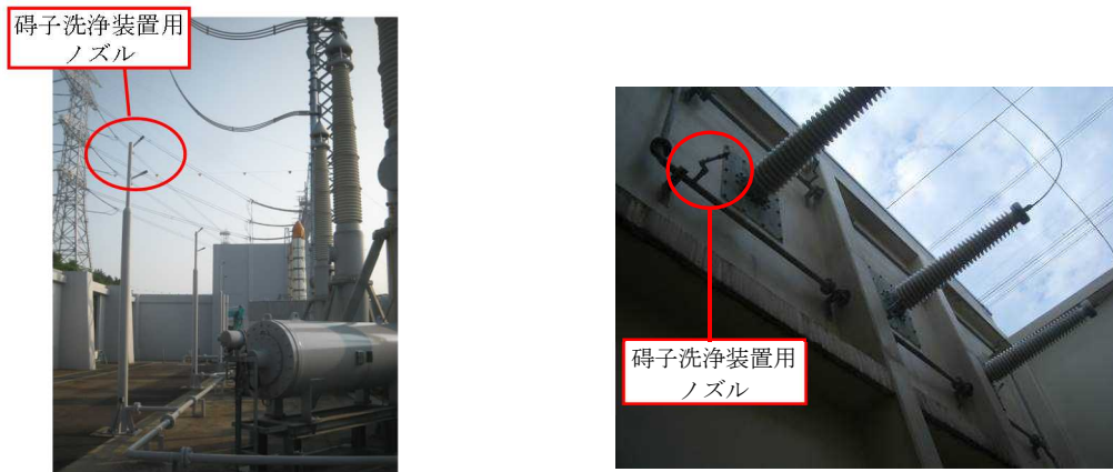
500kV 送電線 (開閉所出口)
