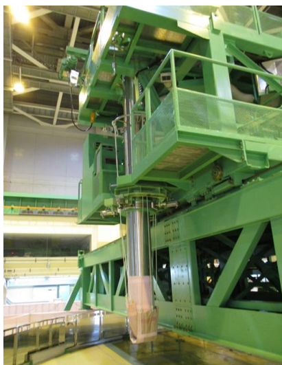
燃料取替機（トロリ）外観
