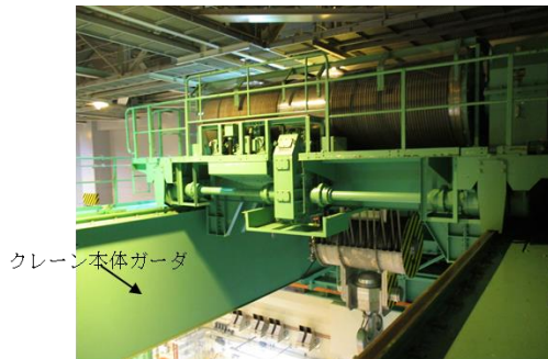
原子炉建屋クレーン外観
