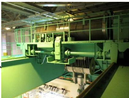
原子炉建屋クレーン外観
