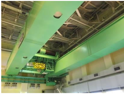
原子炉建屋クレーン外観
