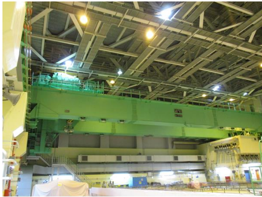
原子炉建屋クレーン外観
