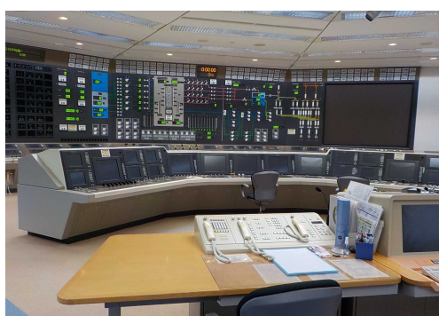
(通常点灯状態)
