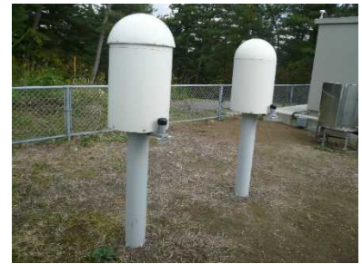
モニタリングポスト設置状況
