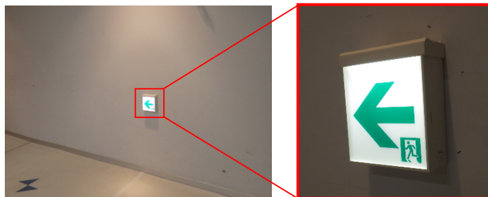
通路誘導灯（廊下・通路）
