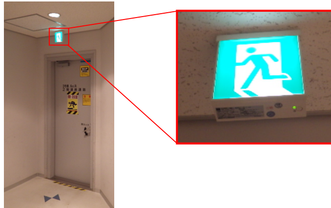
避難口誘導灯
