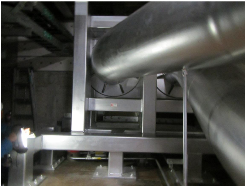
RCW (A) 配管 外観
