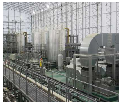
処理水タンク・供給タンク
