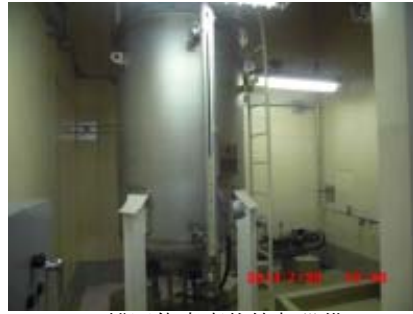
雑固体廃棄物焼却設備 廃油タンク設置状況
